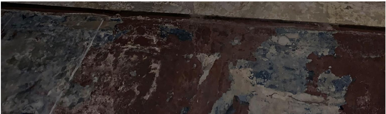
Εσωτερικά επιχρίσματα κακής ποιότητας / εξωτερικά επιχρίσματα
