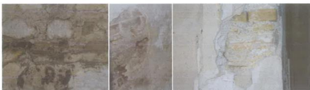
Φωτ. 9. χ. Υ.03 Λιθοδομή με γεμίσματα από οπτόπλινθους Φωτ. 10.χ. Υ.03 εσωτερικός διαχωριστικός τοίχος από οπτόπλινθους Φωτ. 11.χ. Ι.03 μικτή τοιχοποιία
