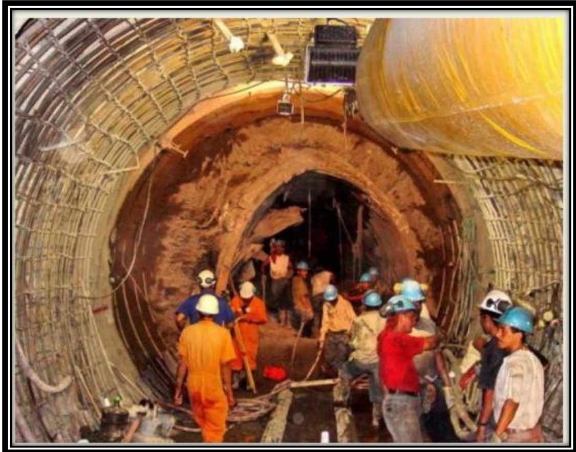
Εικόνα 1: Έντονη σύνθλιψη στη σήραγγα Yasambu-Quibor. Διακρίνονται οι επισκευές της σήραγγας σε τμήμα που υπέφερε από μεγάλες παραμορφώσεις κάτω από υπερκείμενα 1200m σε γραφικούς φυλλίτες (Hoek, notes from the internet, 2007).
