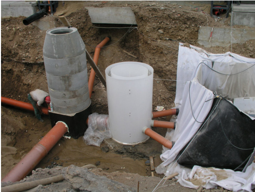
Εικόνα 5: Άποψη φρεατίου συμβολής (Διαδίκτυο 2)
