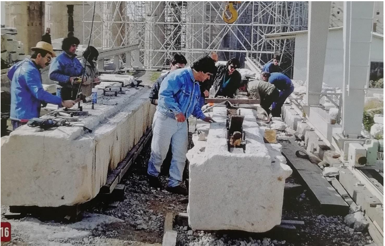
Εικ.60: Αφαίρεση των σιδερένιων οπλισμών της επέμβασης Μπαλάνου από δοκούς της οροφής του Κεντρικού Κτιρίου. Φωτ. Τ. Τανούλας, (ΚΙΖΗΣ Γ. ΑΠΟΚΑΤΑΣΤΑΣΗ ΜΝΗΜΕΙΩΝ ΑΝΑΒΙΩΣΗ ΙΣΤΟΡΙΚΩΝ ΚΤΙΡΙΩΝ ΣΤΗΝ ΑΤΤΙΚΗ, γ'τομος,25.)
