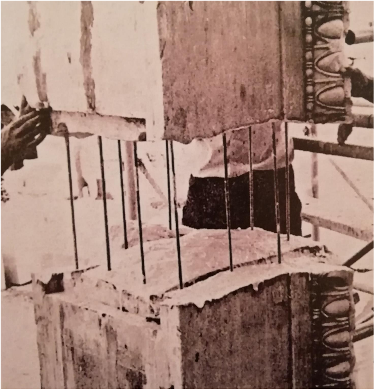
Εικ.48: Σύνδεση δύο τμημάτων μίας δοκού, με οπλισμό τιτανίου – φωτογραφία από την αποκατάσταση του Ερεχθείου. (Κ.Ζάμπας Μ.Ιωαννίδου και Α.Παπανικολάου. Η χρήση οπλισμένου τιτανίου για την αποκατάσταση μαρμάρινων αρχιτεκτονικών μελών των μνημείων της Ακρόπολης, International Institute for Conservation Congress Bologna 1989, Proceeding pp. 138-141).
