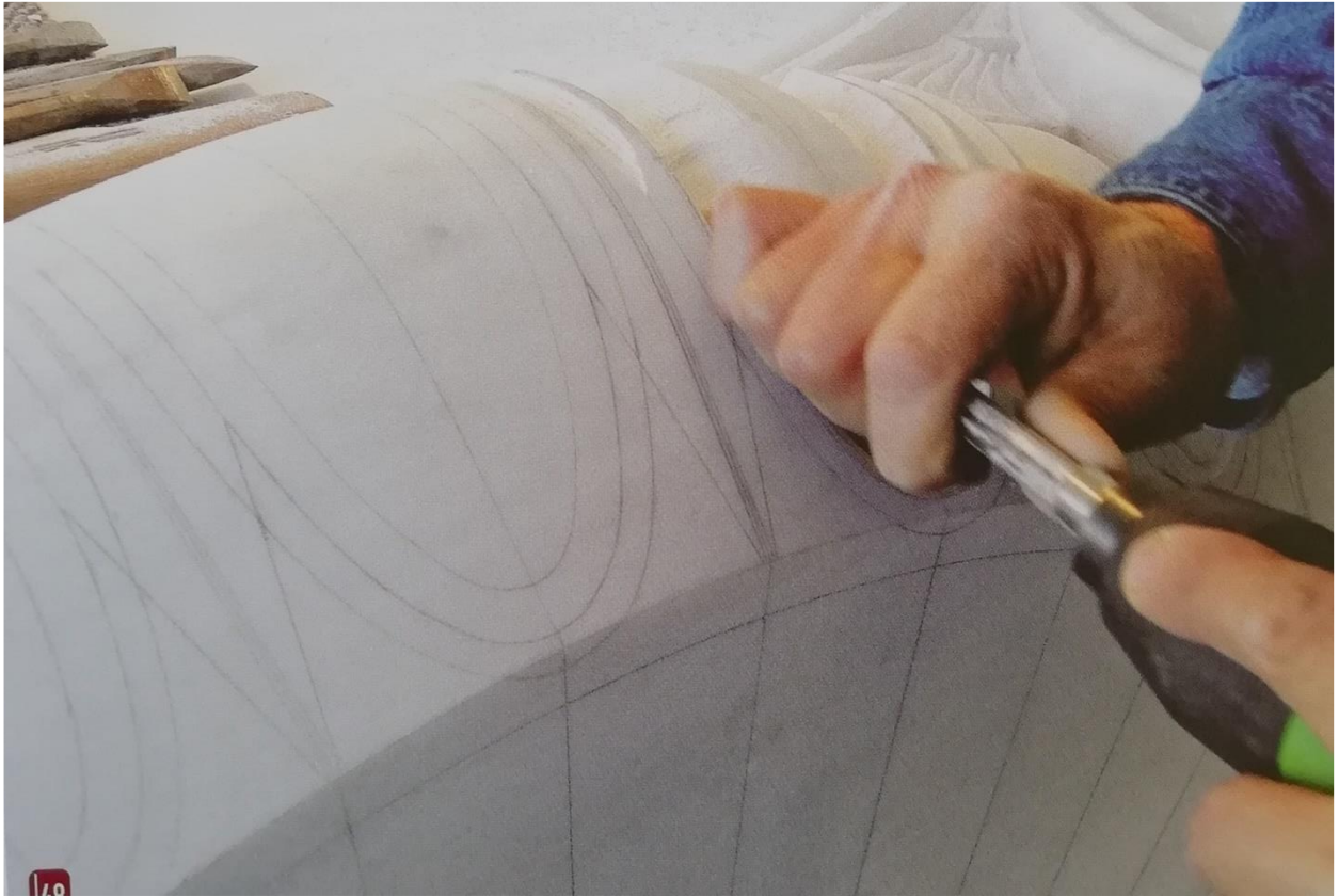
Εικ.83: Λάξευση του αντιγράφου του ιωνικού κιονοκράνου, που κατασκευάστηκε εξ ολοκλήρου από νέο μάρμαρο. Φωτ.: Τ. Τανούλας (ΚΙΖΗΣ Γ. ΑΠΟΚΑΤΑΣΤΑΣΗ ΜΝΗΜΕΙΩΝ ΑΝΑΒΙΩΣΗ ΙΣΤΟΡΙΚΩΝ ΚΤΙΡΙΩΝ ΣΤΗΝ ΑΤΤΙΚΗ, γ' τόμος,39.)
