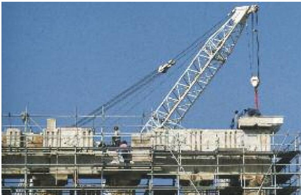
Εικ.21: Επανατοποθέτηση των γείσων της ανατολικής πλευράς του Παρθενώνα. (Φυλλάδιο Αποκαταστάσεις Αρχαίων Μνημείων – Ακρόπολη,8).
