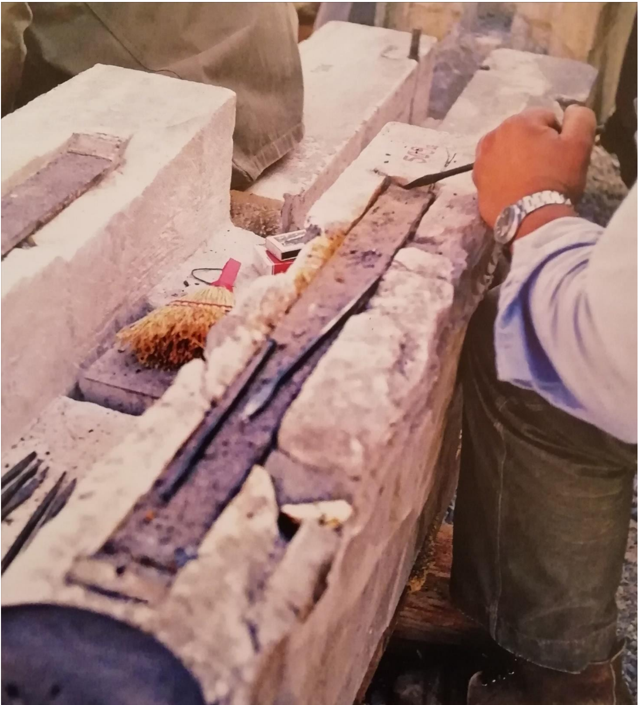
Εικ.37: Οι Μαρμαροτεχνίτες αφαιρούν από κομμάτι του επιστυλίου οξειδωμένους σιδηρούς συνδέσμους της αναστήλωσης Μπαλάνου. (ΚΙΖΗΣ Γ. ΑΠΟΚΑΤΑΣΤΑΣΗ ΜΝΗΜΕΙΩΝ ΑΝΑΒΙΩΣΗ ΙΣΤΟΡΙΚΩΝ ΚΤΙΡΙΩΝ ΣΤΗΝ ΑΤΤΙΚΗ, α' τόμος, 39.)
