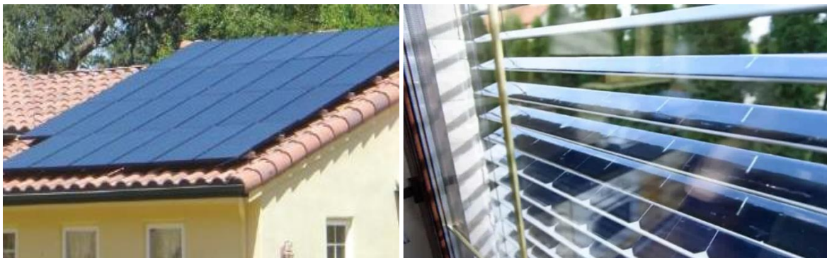
Εικόνα 6.6: BAPV μονάδα εγκατεστημένη σε οροφή (αριστερά) φωτοβολταϊκά στόρια (δεξιά) (44) (46).
