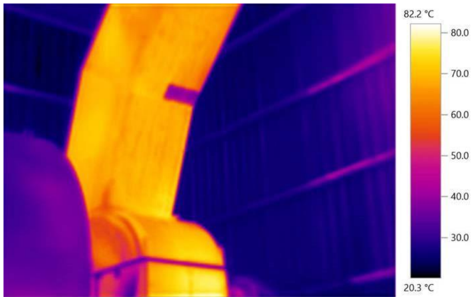
Εικόνα 2.8 :Κάτω τμήμα απαγωγής αερίων ξηραντηρίου
