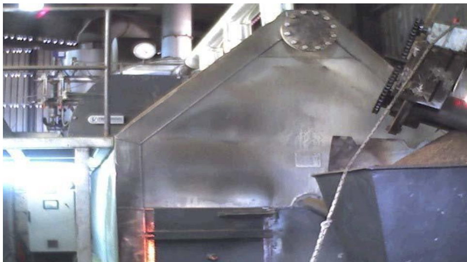
Εικόνα 1.11 :Εστία ατμοπαραγωγού με την προεστία σχήματος Δ
