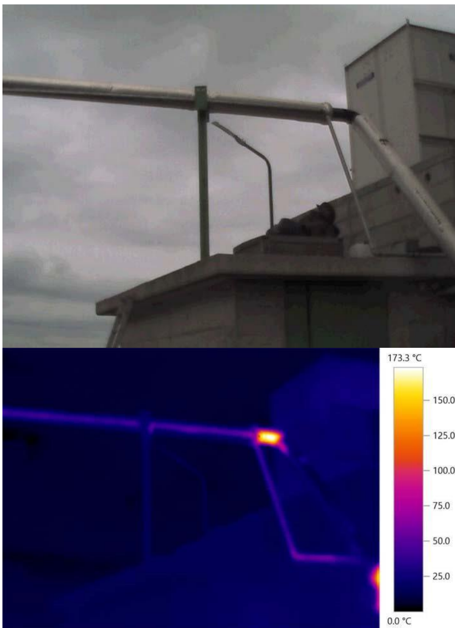
Εικόνα 2.14 :Αγωγός μεταφοράς ατμού
