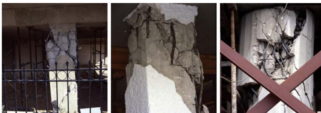
Εικ. 27 Διατμητική αστοχία άκρων υποστυλώματος, λυγισμός ράβδων, θραύση λεπτών συνδετήρων
