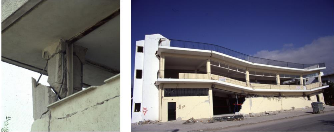
Εικ. 18 Αστοχίες κοντών υποστυλωμάτων
