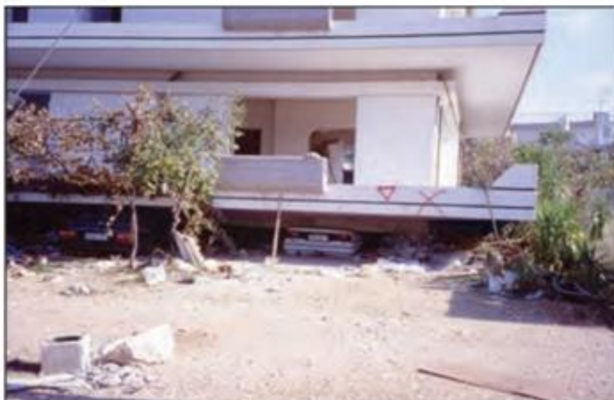
Εικ. 15 Αστοχία πυλωτής
