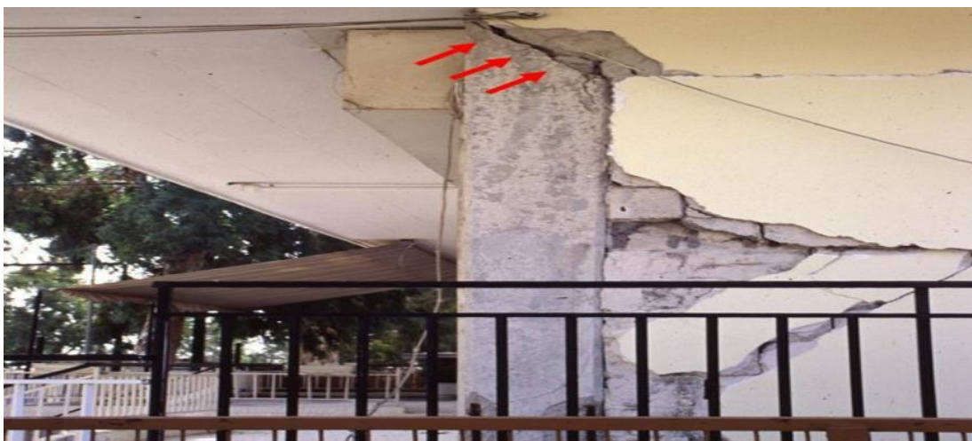
Εικ. 34 Ρηγμάτωση εξωτερικού κόμβου λόγω σύνθλιψης κάτω παρειάς δοκού
