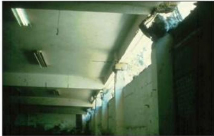
Εικόνα 10: Αστοχία λόγω κοντών υποστυλωμάτων.
