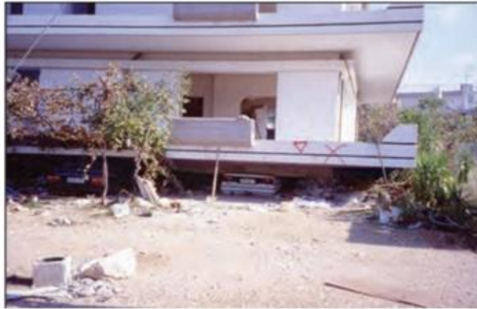
Εικόνα 13: Αστοχία «μαλακού ορόφου».
