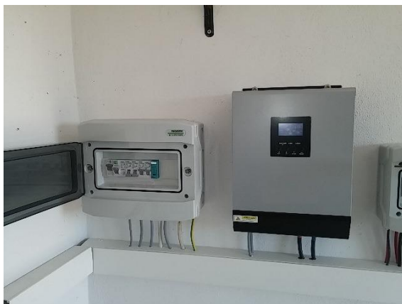
Εικόνα 1.25.: Αντιστροφέας 1Φ σε εγκατάσταση.
