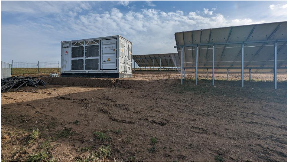
Εικόνα 1.4 Υποσταθμός σε ΦΒ πάρκο ( https://www.pneurope.eu/solar-parks/solar-parks-huawei-builds-first-smart-substation-solar-power-plant-germany )
