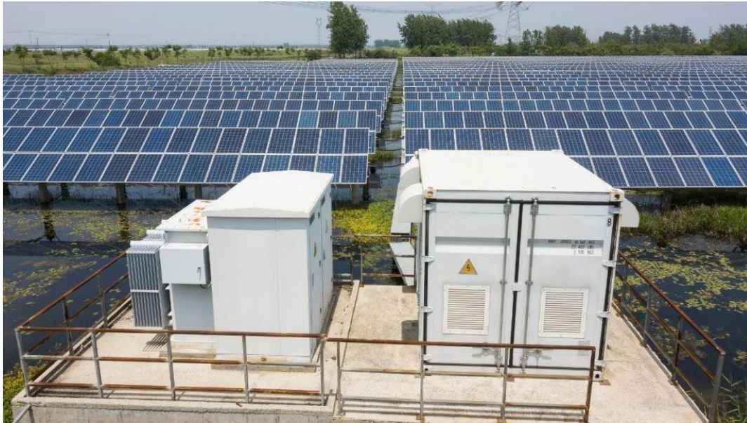
Εικόνα 1.3 Μετασχηματιστής και μετατροπέας σε ΦΒ πάρκο( https://avilasolar.com/a-guide-to-large-photovoltaic-powerplant-design/ )
