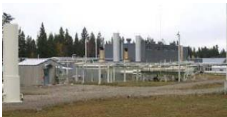
Εικόνα 2.5: Σταθμός συμπίεσης φυσικού αερίου.
