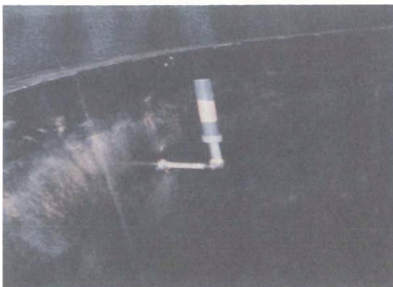
Εικ.4.3. Απορροή για την απομάκρυνση του επιφανειακού λιπαρού στρώματος
