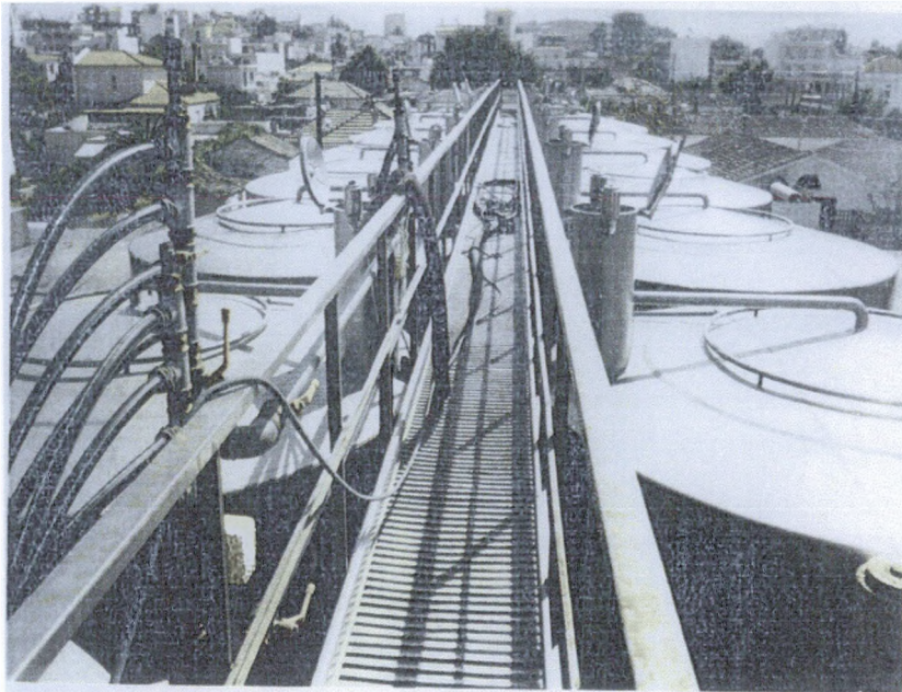
Ανοξείδωτες δεξαμενές γλυκοποίησης
