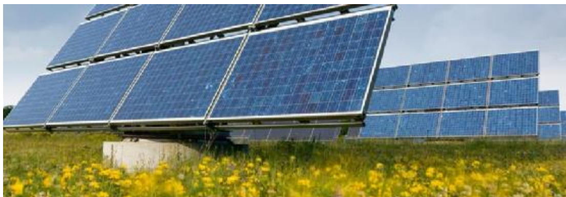
Εικόνα 31: Συστοιχία από κρυσταλλικά φωτοβολταϊκά
