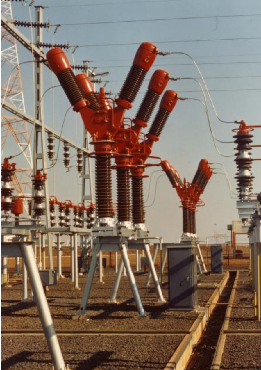
Εικόνα 15: Αυτόματοι διακόπτες «πτωχού» ελαίου
