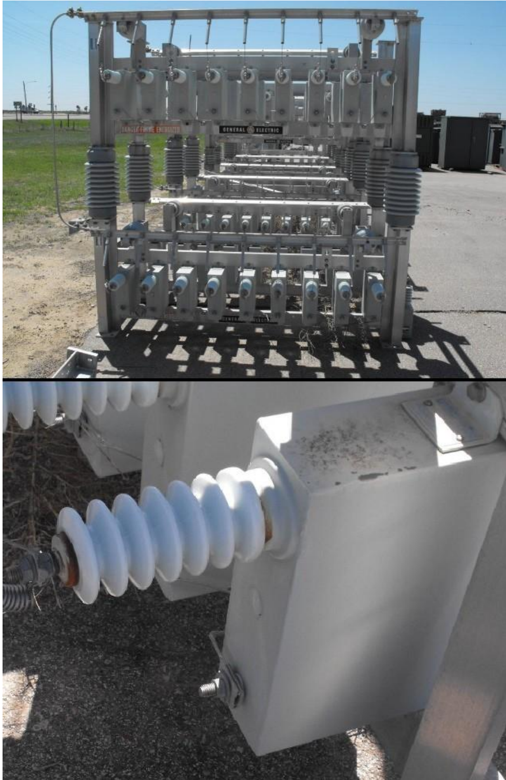
Εικόνα 19: Υπαίθριοι Πυκνωτές Αντιστάθμισης
