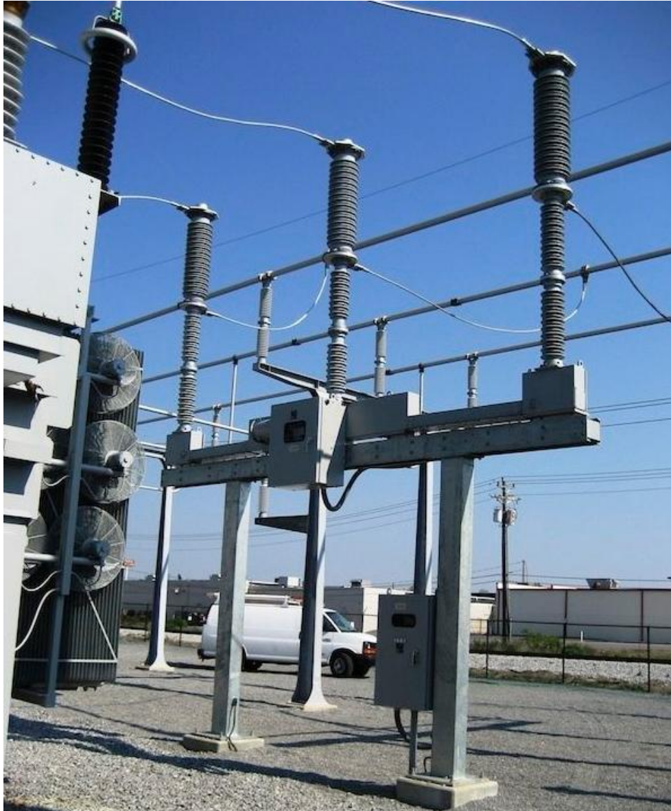
Εικόνα 16: Αυτόματι Διακόπτες Αέρα
