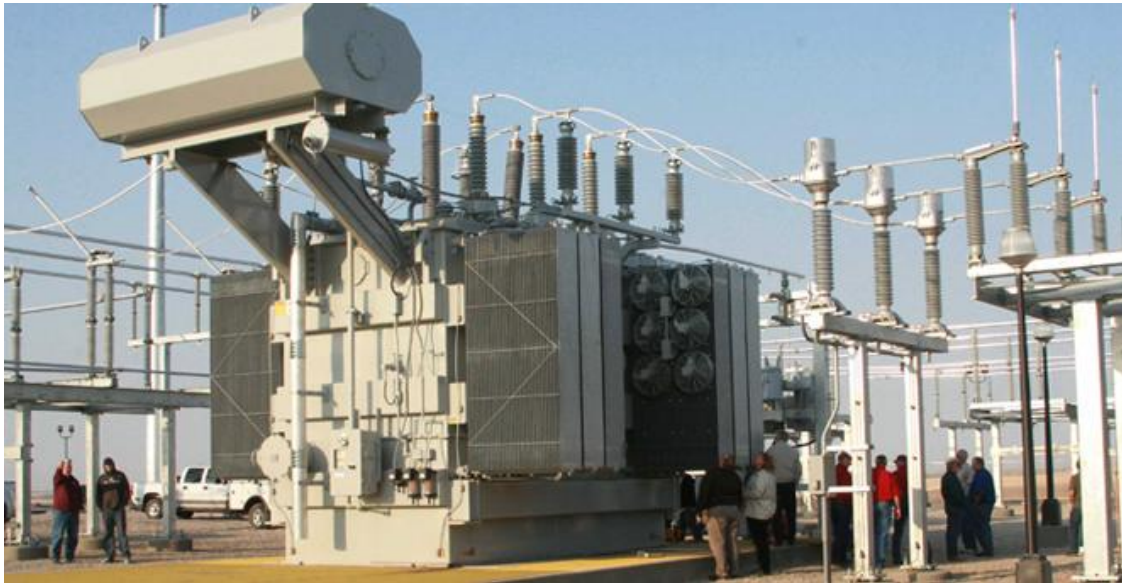
Εικόνα 14: Εξωτερικός ΜΣ υποσταθμού
