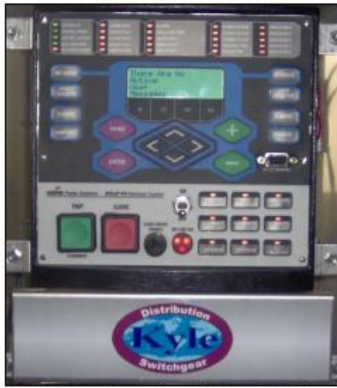
Εικόνα 12: Πίνακας ελέγχου του Δ/ΑΕ ξηρού τύπου NOVA 27
