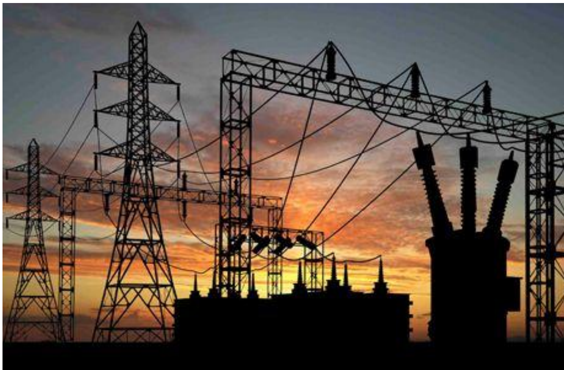
Εικόνα 5: Ζυγοί Υψηλής Τάσης
