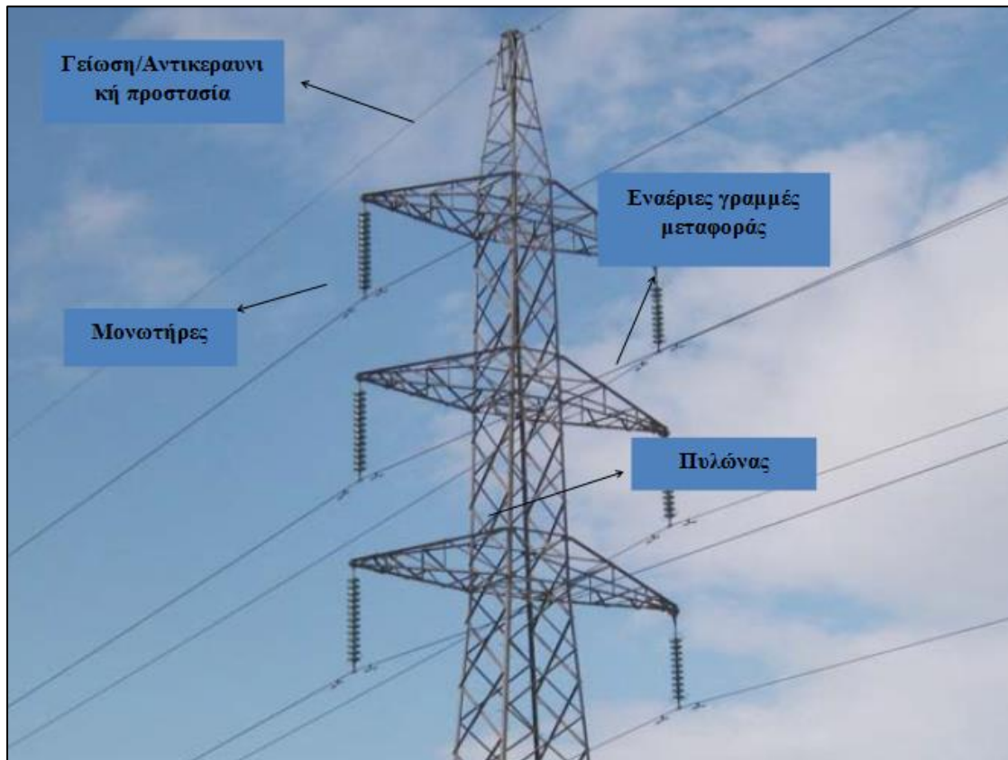
Εικόνα Ν.ο. 5 Γραμμές μεταφοράς υψηλής τάσης 150kV και 400 kV
