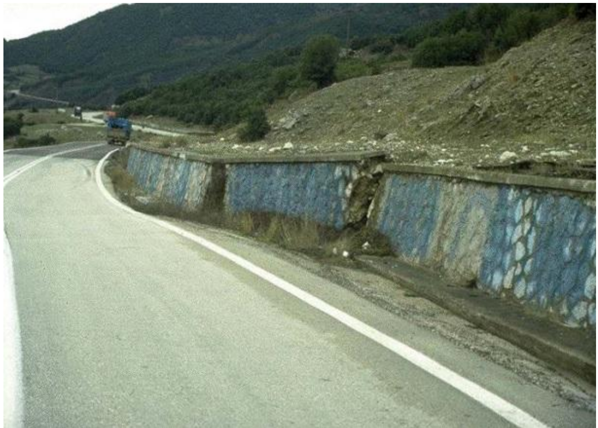
Τοίχος αντιστήριξης σε αστοχία
