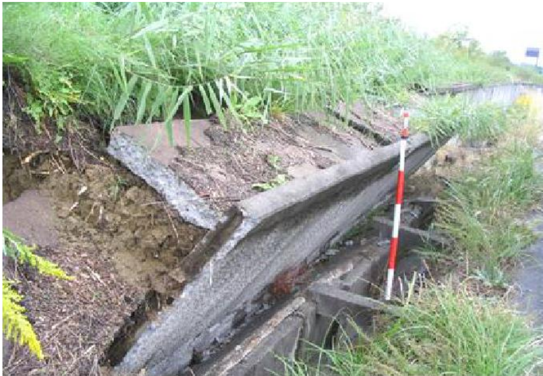
Αστοχία τοίχου αντιστήριξης από σκυρόδεμα τύπου L
