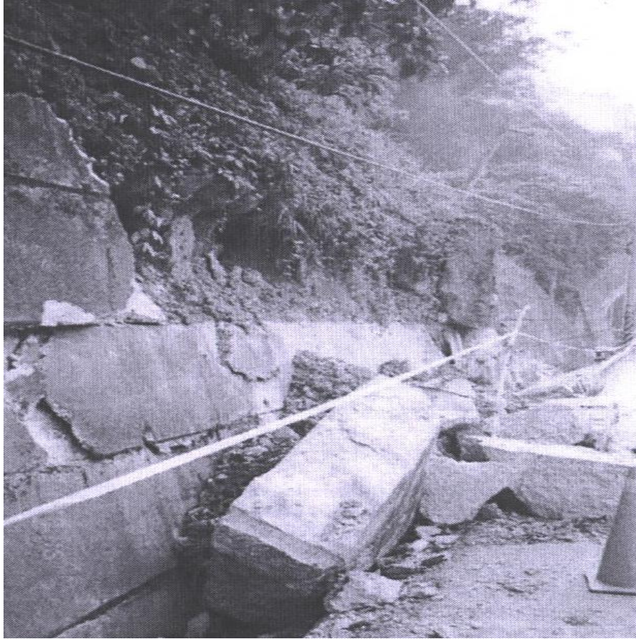
Αστοχία τοίχου βαρύτητας λόγω ολίσθησης μεταξύ των αρμών
