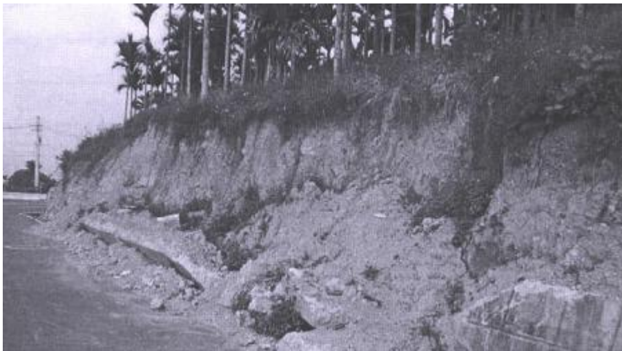
Αστοχία τοίχου βαρύτητας λόγω ανατροπής
