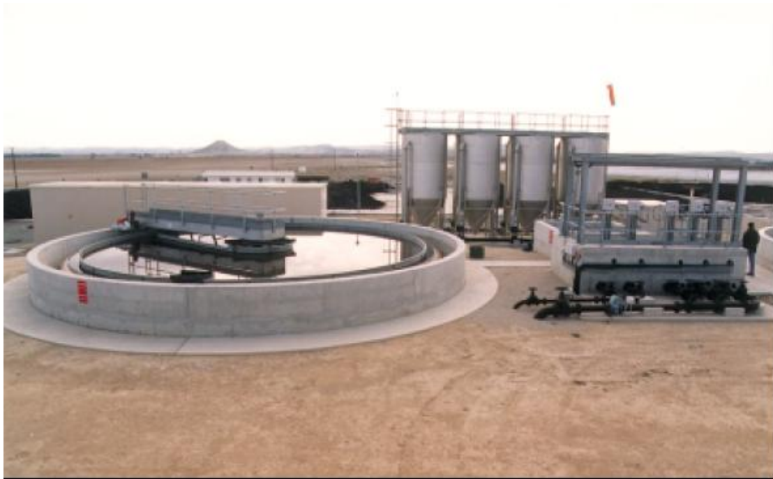
Εικόνα 2- 5 : Δεξαμενή δευτεροβάθμιας καθίζησης
