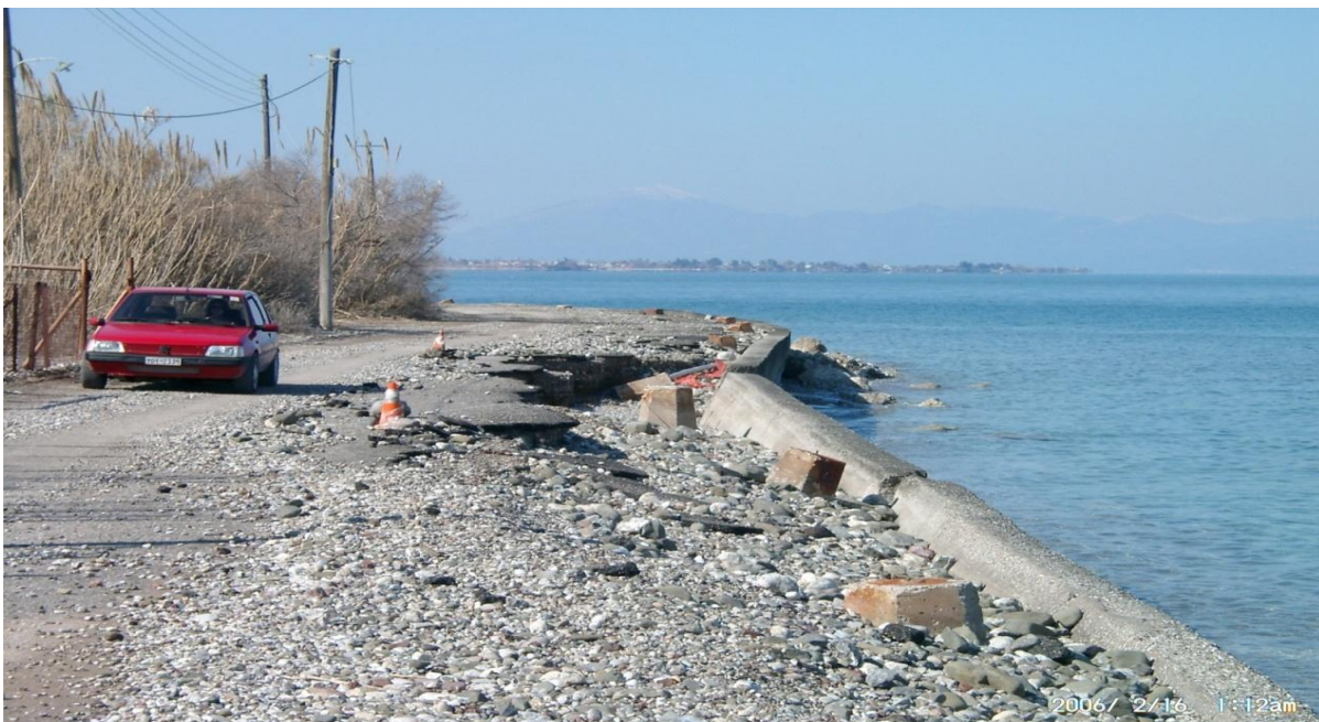
Εικόνα 27. Εξέλιξη Διάβρωσης – Προστασία παραλιακού δρόμου με Τοίχιο Σκυροδέματος (Δήμος Συμπολιτείας Ν. Αχαΐας). (Χ. Καπόπουλος, 2010)
