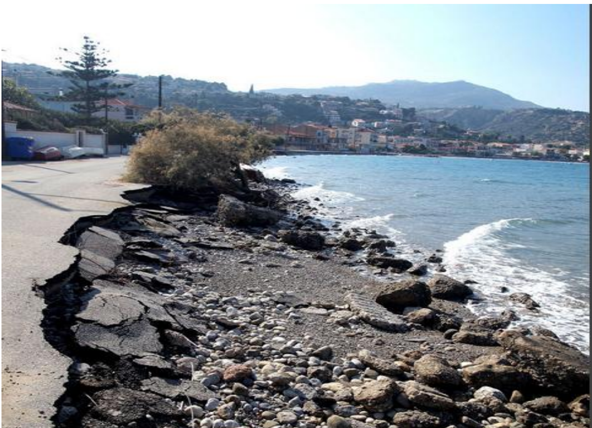
Εικόνα 19. Περιοχή στο ανατολικό Αίγιο που έχει υποστεί διάβρωση. ( www.styga.gr )
