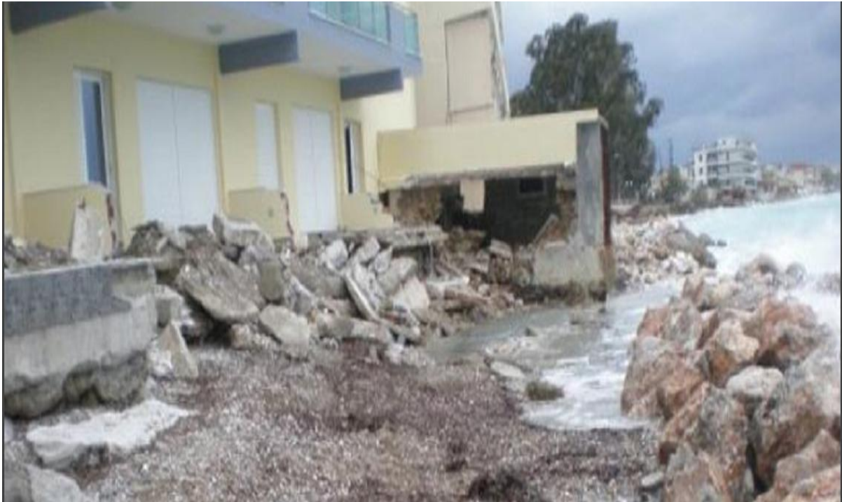
Εικόνα 18. Το φαινόμενο της διάβρωσης στο Ξυλόκαστρο. ( www.sfedona.gr )
