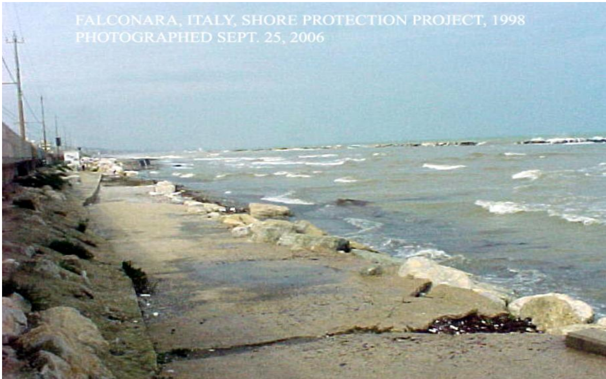
Εικόνα 30. Αστοχία Παραλιακών Υποδομών-Προστασία ακτής με κυματοθραύστες (Falconara, Italy 2006). (Χ. Καπόπουλος, 2010)
