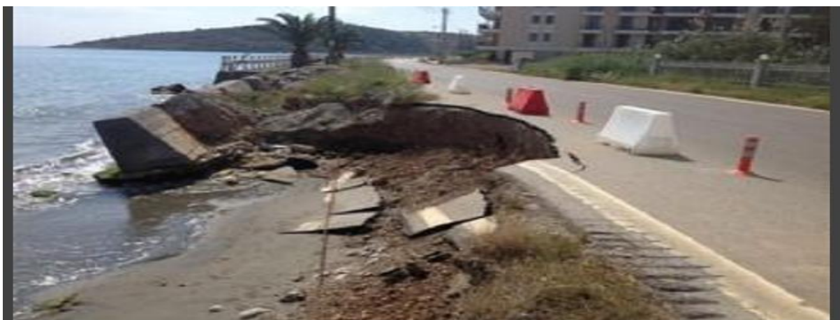
Εικόνα 37. Διαβρωμένη ακτή στην περιοχή Ατσιγγάνου ( www.arcadiaportal.gr )
