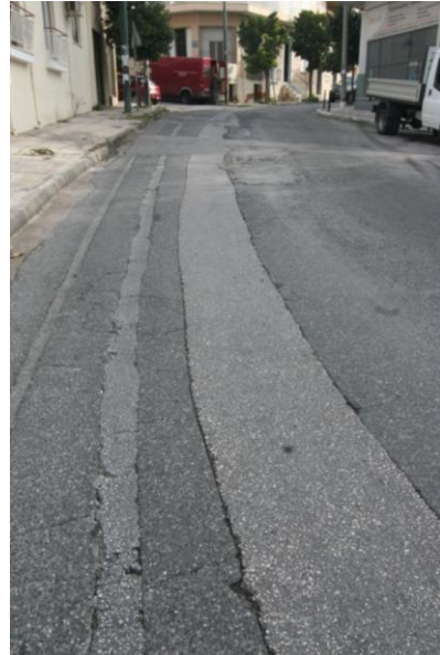
Εικόνα 37_Κακή κατάσταση δρόμων
