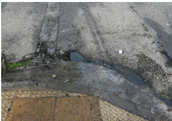
Εικόνα 39_Κακή κατάσταση πεζοδρομίων
