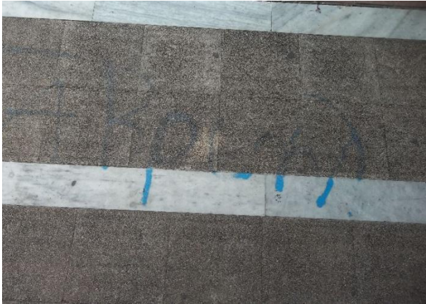
Εικόνα 55_Καταστροφές στην πλακόστρωση
