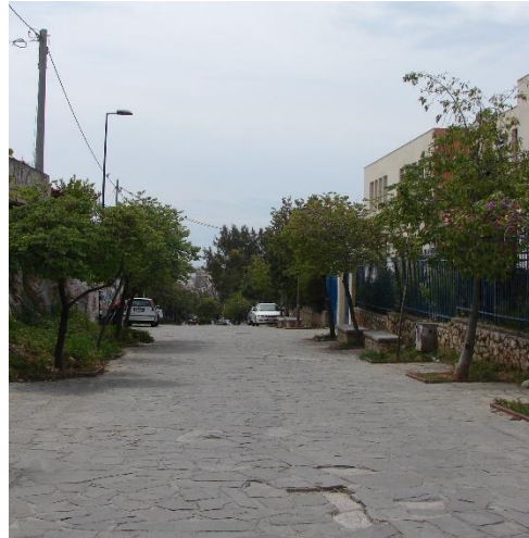
Εικόνα 43_Αποκόλληση πλακών πεζοδρόμου
