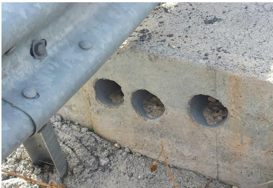
Φωτ. 6.11 Απολήξεις των υποδομών (σωληνώσεων) για δίκτυα (ύδρευσης, παροχή ρεύματος κλπ.) στο άκρο του πεζοδρομίου.
