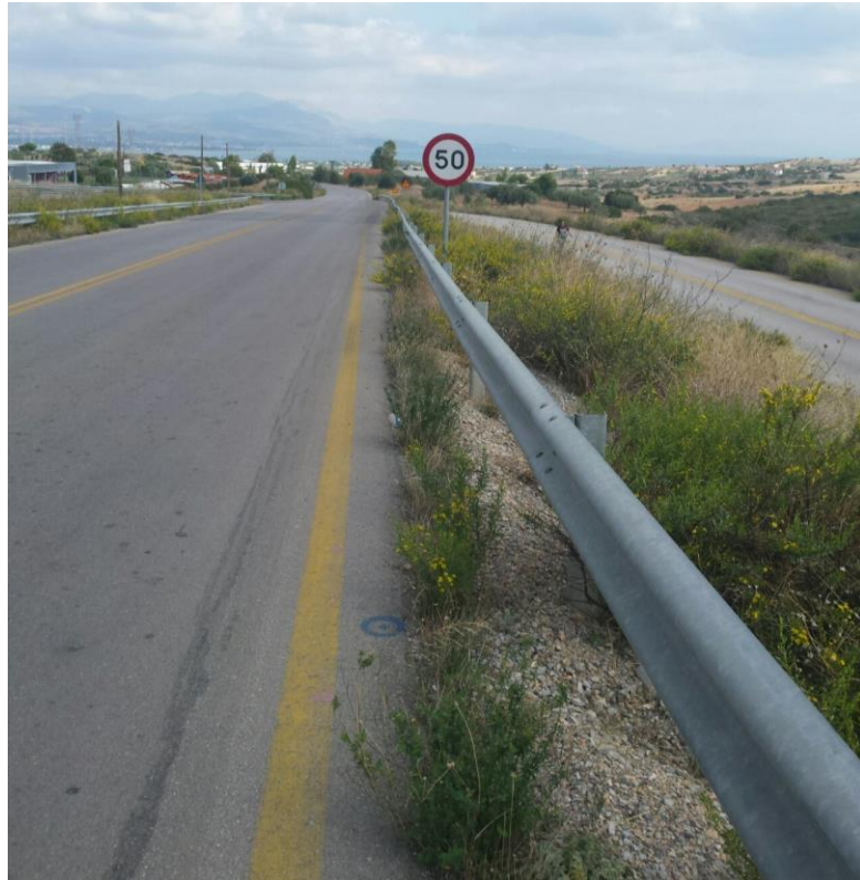
Φωτ. 6.5 Άποψη της γέφυρας φωτογραφημένης από το ρεύμα του οδοστρώματος με κατεύθυνση προς Καλοχώρι.
