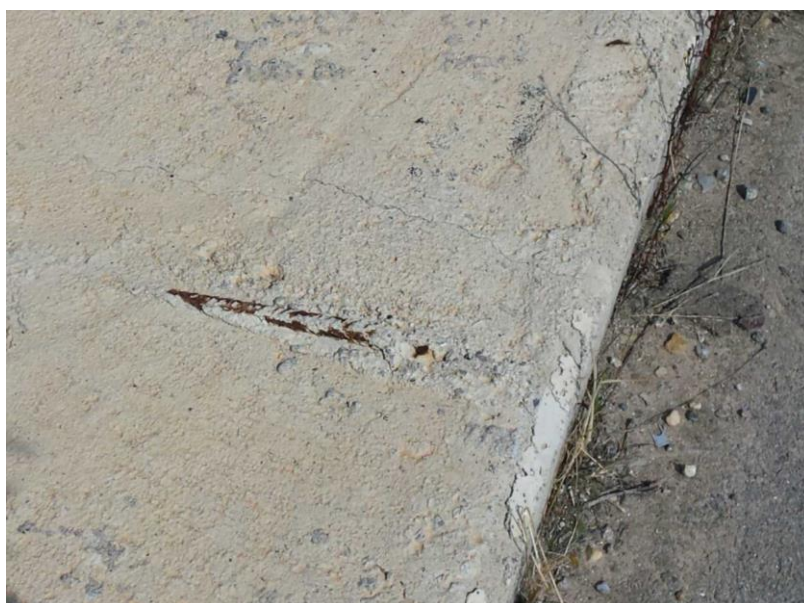
Φωτ. 6.14 Αποκάλυψη οπλισμών σε πεζοδρόμιο της γέφυρας λόγω πλημμελούς κατασκευής στη συγκεκριμένη θέση.
