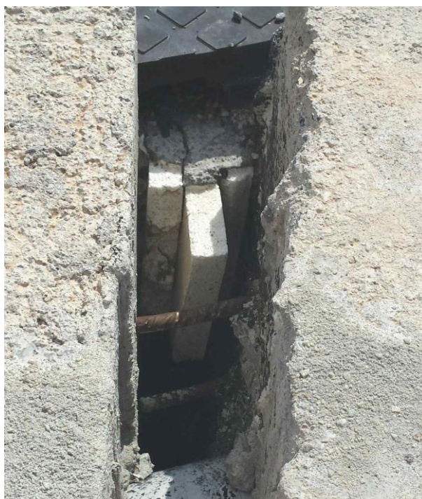
Φωτ. 6.10 Λεπτομέρεια από το διάκενο του αρμού στο Νοτιοδυτικό άκρο της γέφυρας στη θέση του πεζοδρομίου.
