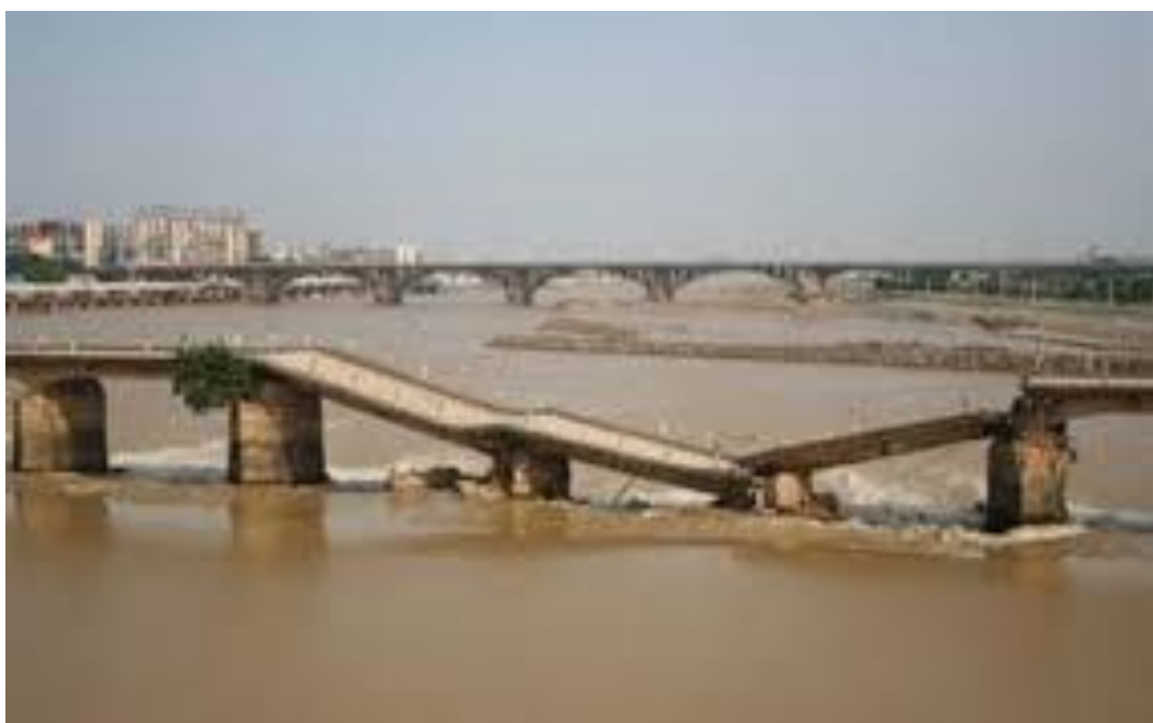
Φωτ. 3.1 Απώλεια στήριξης της ανωδομής.
