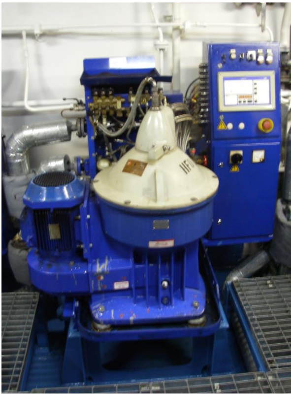
Εικόνα 1.1: Διαχωριστήρας σε εγκατάσταση
