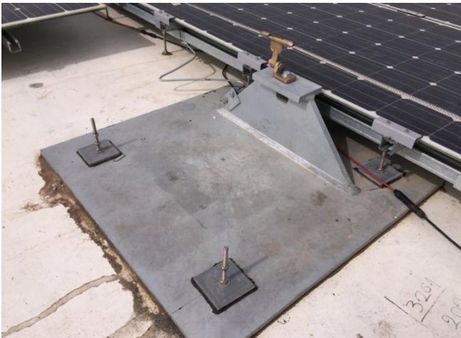
Επαναλαμβανόμενο στοιχείο που ενώνεται με το στεγάστρο και χρησιμοποιείται από τους συντηρητές των φωτοβολταϊκών
