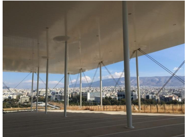
Δομικά στοιχεία στήριξης του ενεργειακού στεγάστρου και οι αντίστοιχες περιμετρικές καλωδιώσεις σχήματος Χ
