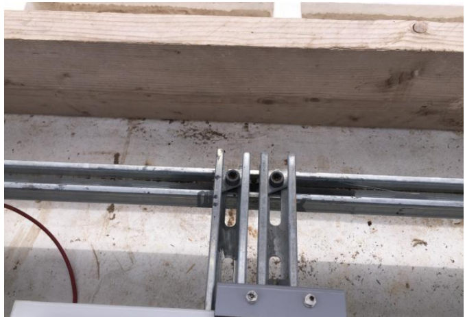
Τα κενά που διαθέτει κάθε ράγα χρησιμοποιούνται για την τοποθέτηση της καλωδίωσης των Φωτοβολταϊκών Πάνελ
