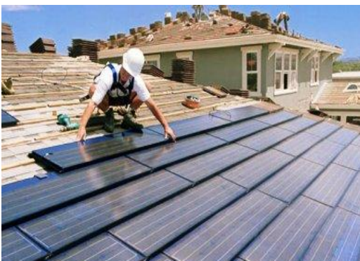
Σύστημα φωτοβολταϊκών Πάνελ σε επικλινή στέγη
