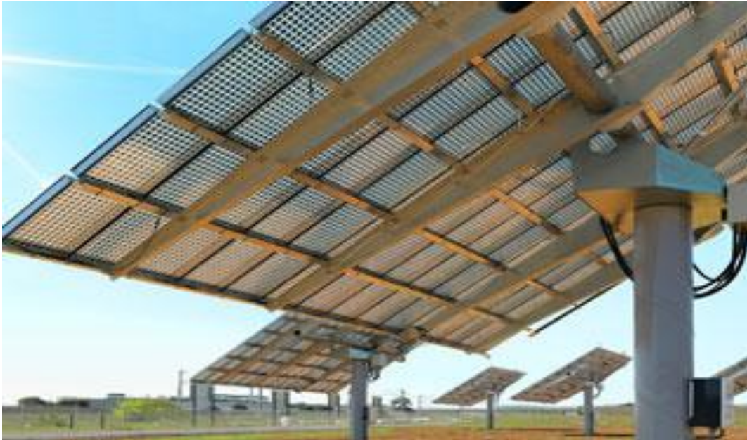
Σύστημα παρακολούθησης ηλιακής ακτινοβολίας
