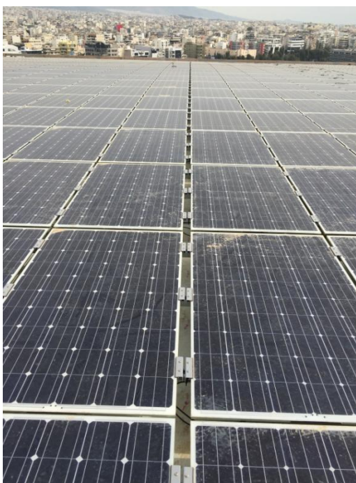
Άποψη των φωτοβολταϊκών Πάνελ
