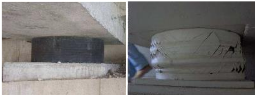
Σχήμα 15 Πλευρική διόγκωση εφεδράνου
