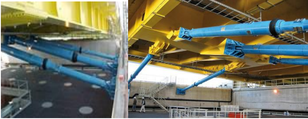
Σχήμα 19 Αποσβεστήρες στη γέφυρα Ρίου – Αντιρρίου [15]
