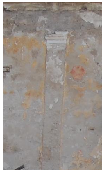
Εικόνα 3.32. Αποκόλληση επιχρίσματος ψευδοπεσσού.
