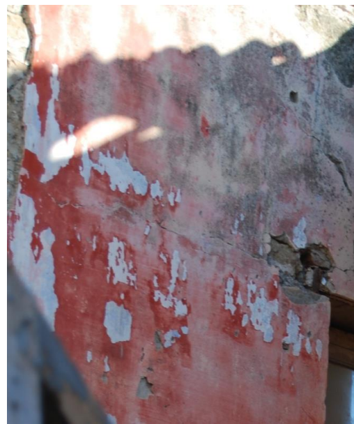
Εικόνα 3.28. Αποκόλληση και φουσκώματα λόγω υγρασίας
