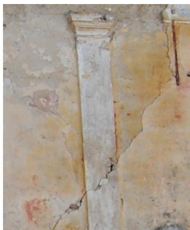
Εικόνα 3.8. Ρωγή τοιχοποιίας ανατολικής όψης.
