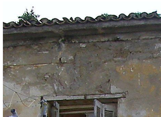
Εικόνα 3.5. Απώλεια εξωτερικής στρώσης και τοπική εμφάνιση βλάστησης
