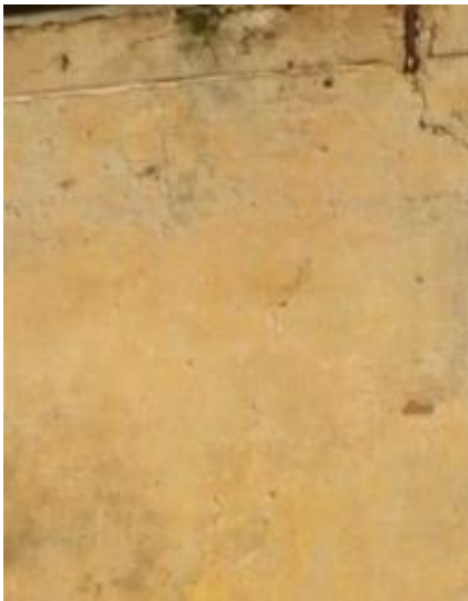
Εικόνα 3.27. Ξεθώριασμα χρωματισμού λόγω υγρασίας
