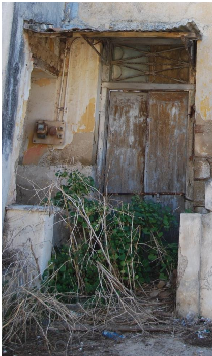
Εικόνα 3.17. Σαπισμένη πόρτα ισόγειο και οξειδωμένα μεταλλικά στοιχεία.
