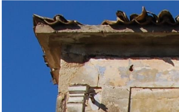
Εικόνα 3.30. Ρηγματώσεις στο γείσο.
