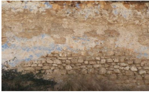
Εικόνα 3.39. Αποσάθρωση επιχρίσματος της μάντρας.
