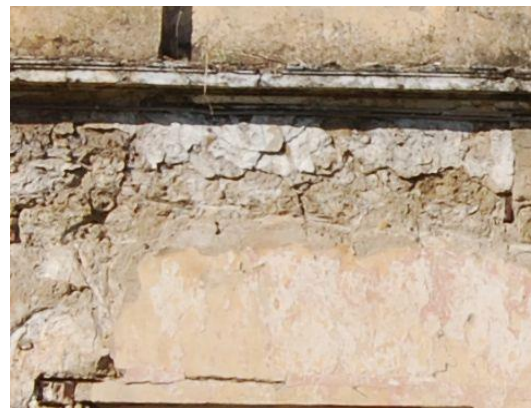
Εικόνα 3.3. Τοπική απώλεια Αρμολογήματος
