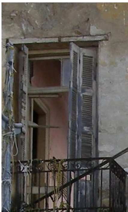
Εικόνα 3.19. Σαπισμένα ξύλινα μέλη και απώλεια υαλοπινάκων.
