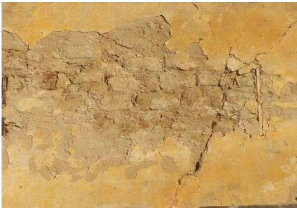
Εικόνα 3.2. Απώλεια εξωτερικής στρώσης και τοπική απώλεια επιχρίσματος
