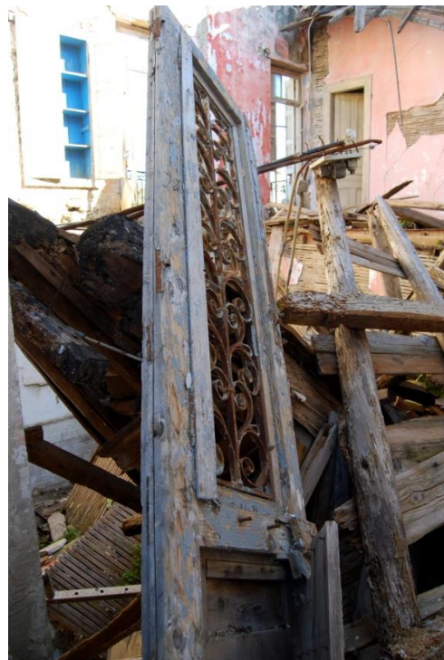
Εικόνα 3.18. Κατεστραμμένη πόρτα ορόφου
