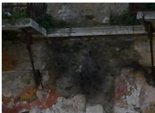
Εικόνα 3.10. Μούχλα στην τοιχοποιία
