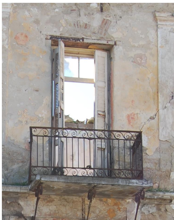
Εικόνα 3.20. Σαπισμένα ξύλινα μέλη και απώλεια υαλοπινάκων.
