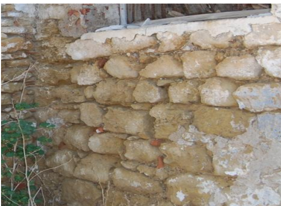
Εικόνα 3.4. Αποσάθρωση επιχρίσματος και τοπική απώλεια αρμολογήματος
