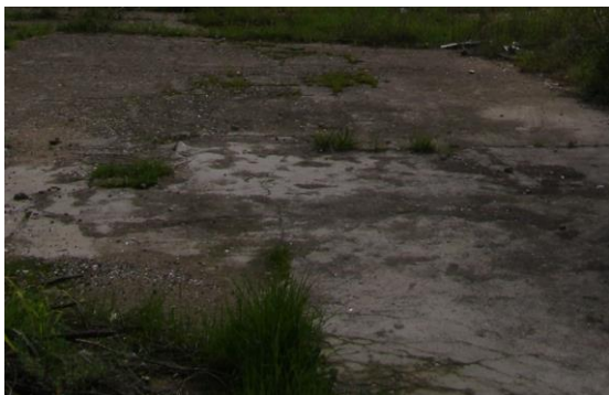
Εικόνα 3.35. Ρηγματωμένο σκυρόδεμα προαυλίου.
