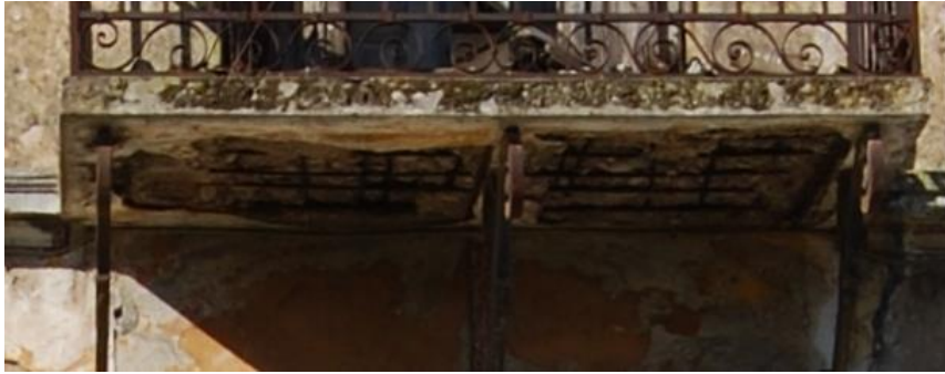
Εικόνα 3.33. Αποκάλυψη οπλισμού μπαλκονιού.
