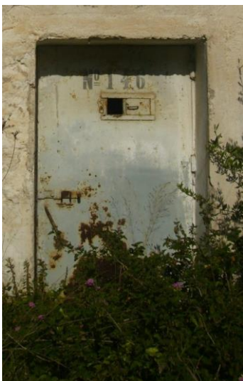
Εικόνα 2.12. Μεταλλική πόρτα κελιού.
