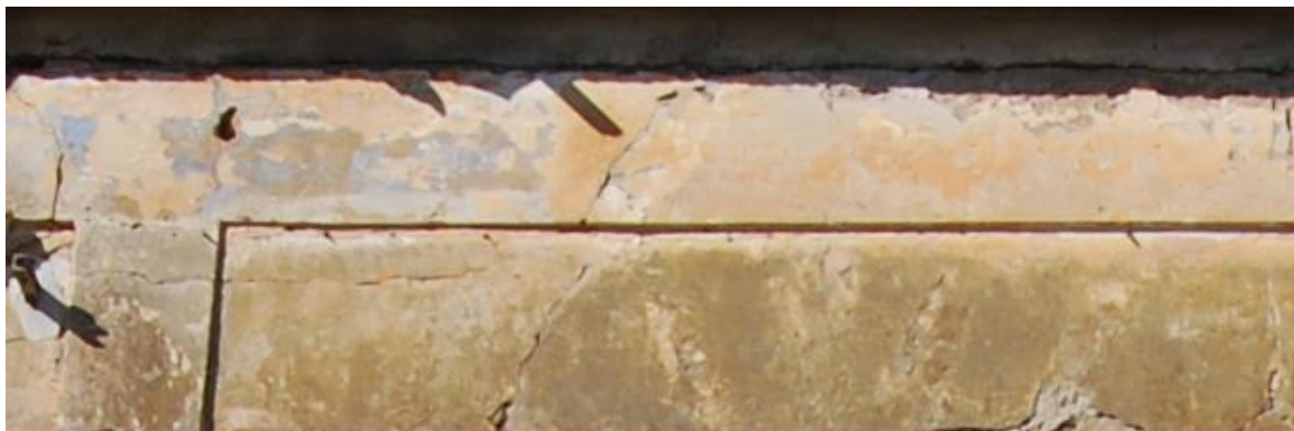
Εικόνα 3.29. Ξεθώριασμα χρωματισμού λόγω υγρασίας.
