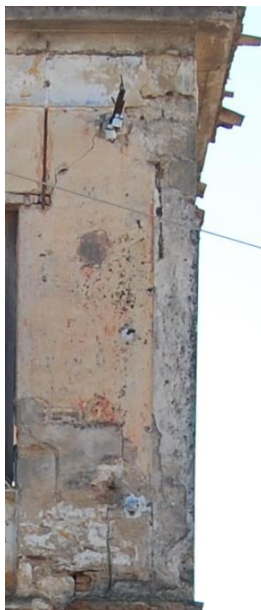
Εικόνα 3.31. Κατεστραμμένο τμήμα ψευδοπεσσού.
