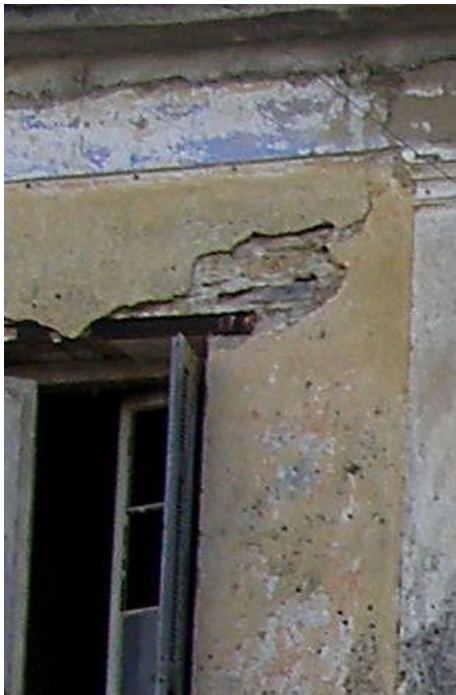
Εικόνα 3.6 Τοπική απώλεια επιχρίσματος
