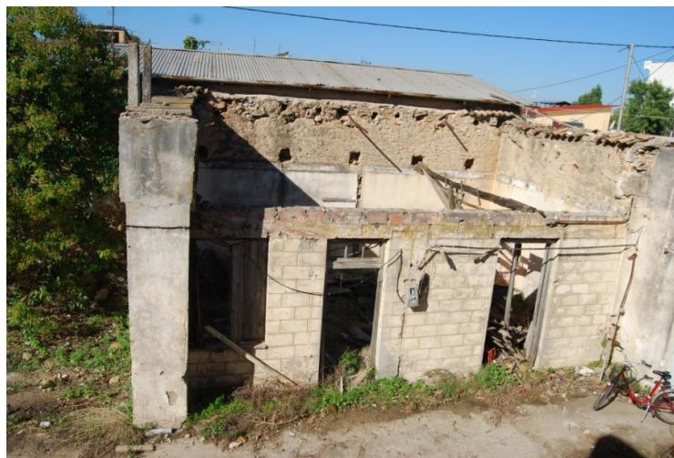
Εικόνα 3.41. Βλάβες σε βοηθητικό κτίριο.
