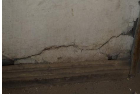
Εικόνα 90. Λεπτομέρεια τριχοειδής ρωγμή
