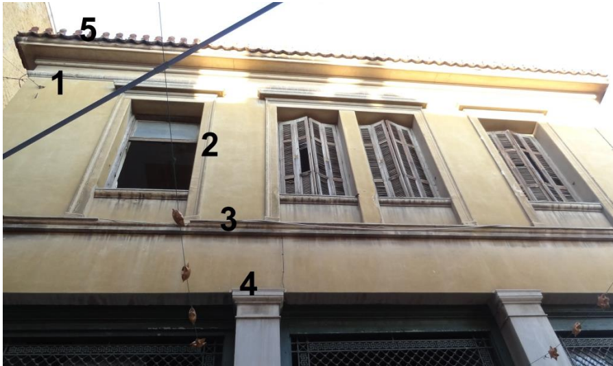
Εικόνα 69. Λεπτομέρειες δυτικής όψης: 1) Γείσο επίστεψης, 2) Τραβηχτές κορνίζες ανοιγμάτων, 3) Γείσο στο επίπεδο του ορόφου, 4) Επίκρανα στις κολώνες, 5) Ακροκέραμα
