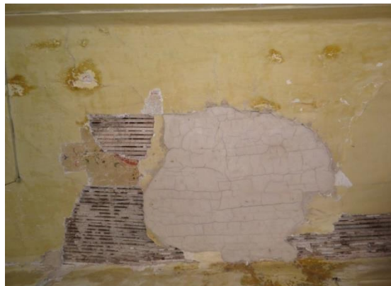
Εικόνα 102. Λεπτομέρεια φθορές οροφής
