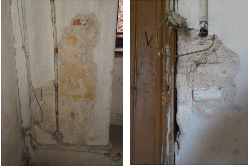
Εικόνα 97. Λεπτομέρεια αποφλοίωση επιχρίσματος
