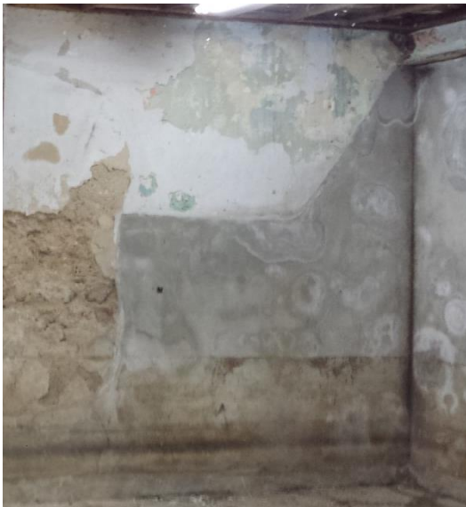
Εικόνα 88. Λεπτομέρεια κατάρρευση επιχρίσματος υπογείου
