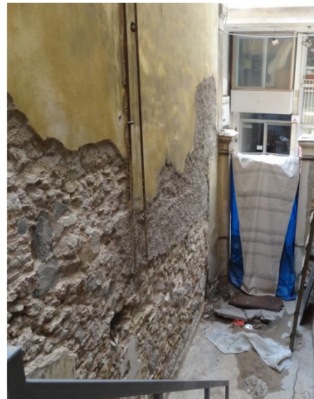
Εικόνα 87. Λεπτομέρεια κατάρρευση επιχρίσματος βόρειας όψης
