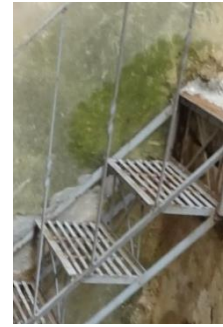
Εικόνα 89. Λεπτομέρεια βιοδιάβρωση, μούχλα
