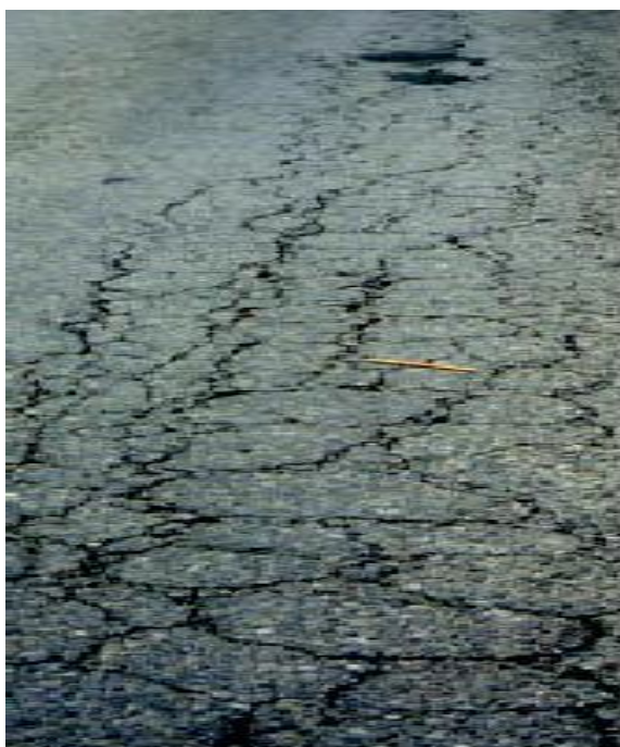
Εικόνα 42. Ρηγματώσεις τύπου αλιγάτορα.
