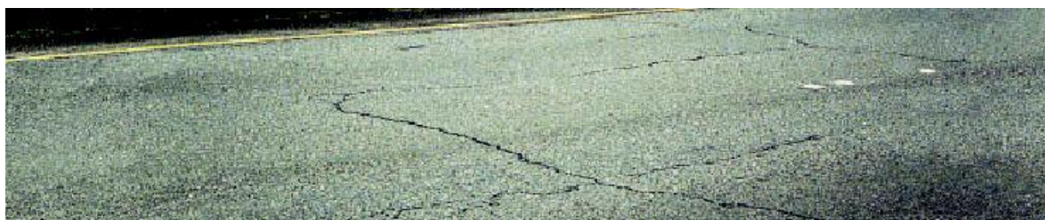
Εικόνα 50. Ρηγμάτωση του οδοστρώματος κατά τεμάχια
