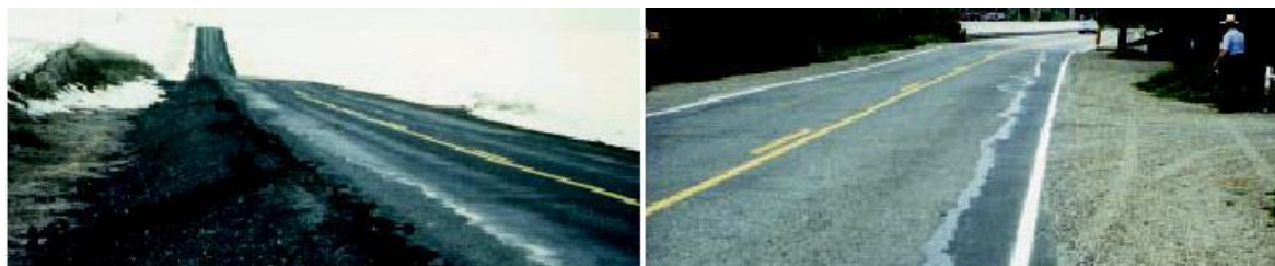
Εικόνα 51. Αποκόλληση αδρανών στις ακμές του οδοστρώματος
