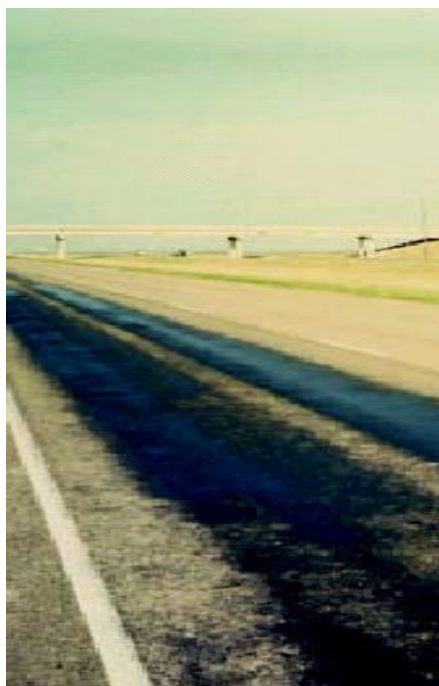
Εικόνα 47. Εκχείλιση / Εφίδρωση οδοστρώματος
