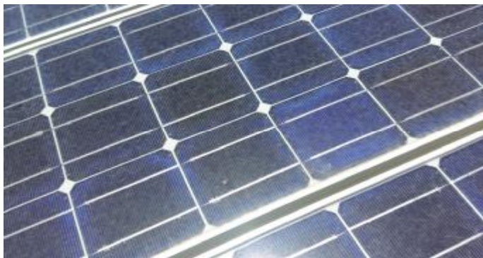
8.5.1 Εικόνα: Το Φ/Β πλαίσιο E_v1 στο οποίο φαίνεται το σημείο στο οποίο υπάρχει υποβάθμιση στο ARC.
