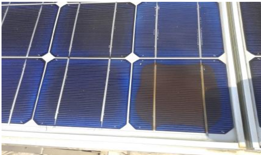
8.2.1 Εικόνα .Το Φ/B πλαίσιο B_v4 στο οποίο φαίνονται χαρακτηριστικά σημεία υποβάθμισης του ARC και της οξείδωσης στο busbar η οποία δημιουργεί αποκόλληση.
