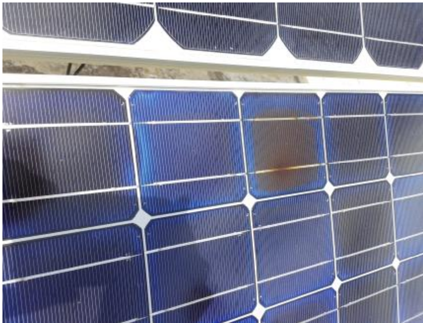
8.4.1 Εικόνα: Το Φ/Β πλαίσιο D_v1 στο οποίο φαίνεται το σημείο στο οποίο υπάρχει οξείδωση λόγω EVA.
