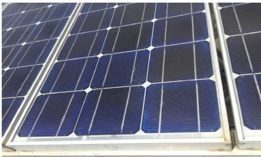
8.4.2 Εικόνα: Το Φ/Β πλαίσιο D_v1 στο οποίο φαίνεται το σημείο στο οποίο υπάρχει υποβάθμιση στο ARC.
