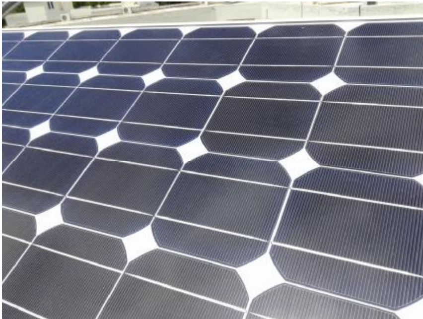
8.9.1 Εικόνα: Το Φ/Β πλαίσιο SW-KEK στο οποίο φαίνεται το σημείο στο οποίο υπάρχει μικρή υποβάθμιση στο ARC
