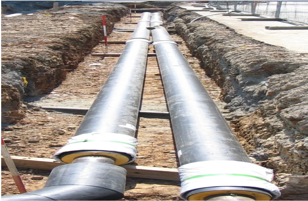
Τηλεθέρμανση στην περιοχή Tübingen, Γερμανία.
