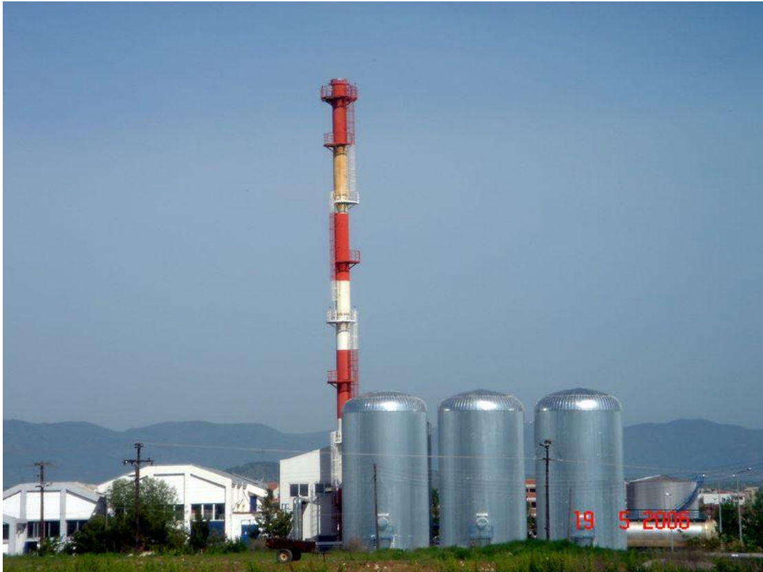
Μονάδα τηλεθέρμανσης στην Πτολεμαΐδα
