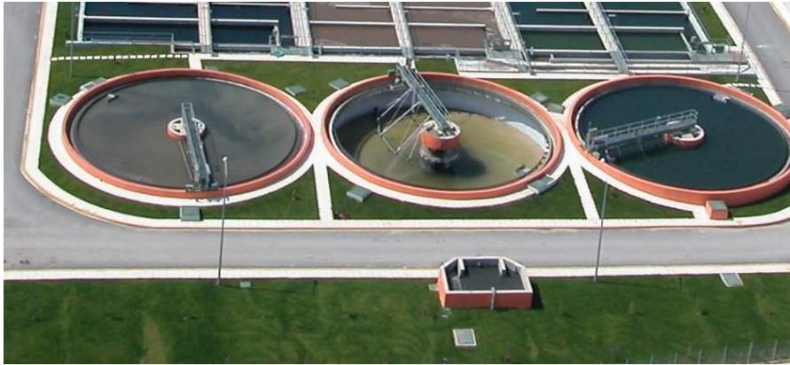
Εικόνα 2.5: Δεξαμενές πρωτοβάθμιας καθίζησης βιολογικού καθαρισμού Πάτρων.
