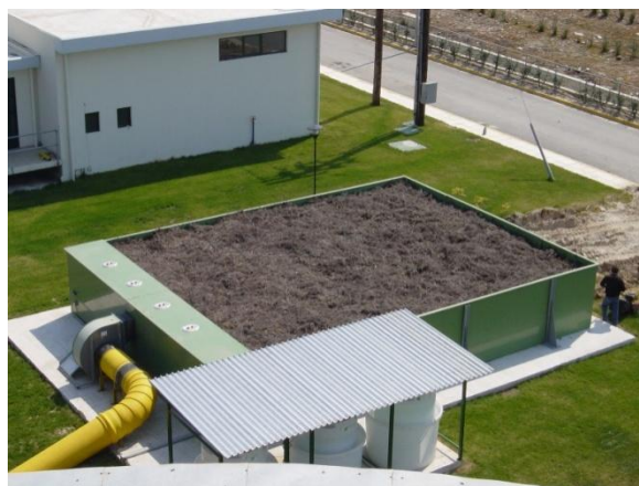
Εικόνα 2.15: Σύστημα απόσπηση Βιολογικού Καθαρισμού Πατρών.
