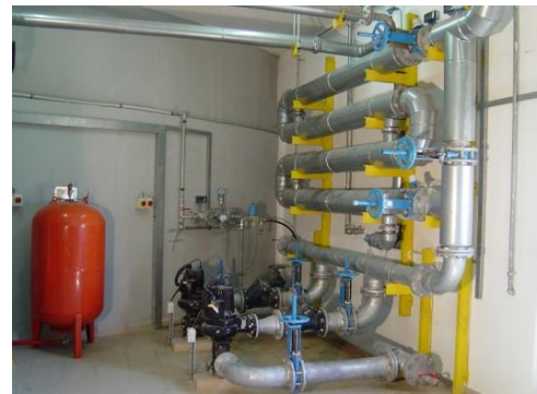
Εικόνα2.17: Σύστημα θέρμανσης ιλύος
