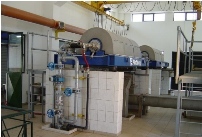
Εικόνα 2.13: Μονάδα πάχυνσης Βιολογικού Καθαρισμού Πατρών.
