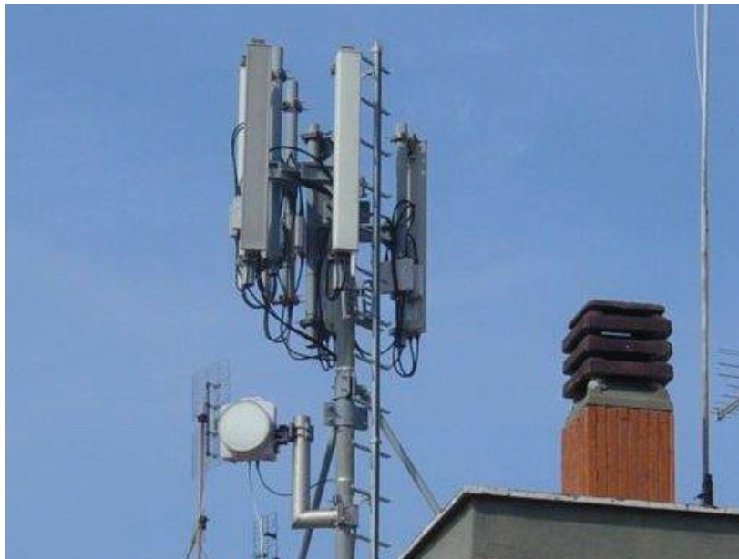
Ε 4.2.1.1: Σταθμός Βάσης
