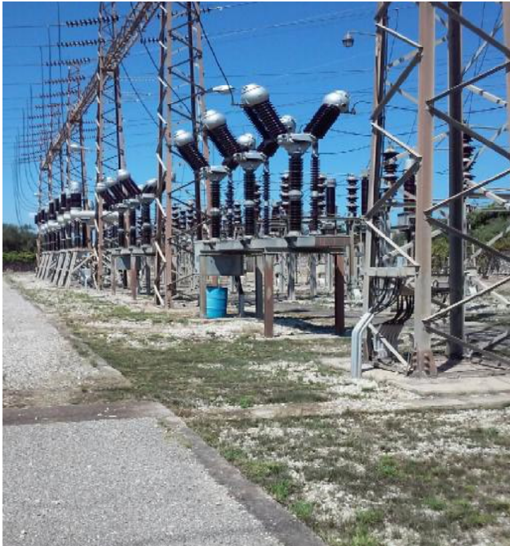
Σχήμα 2.20. Στην παραπάνω εικόνα εμφανίζεται η εγκατάσταση των ζυγών των 150 KV στον υποσταθμό του Πάτρα II .
