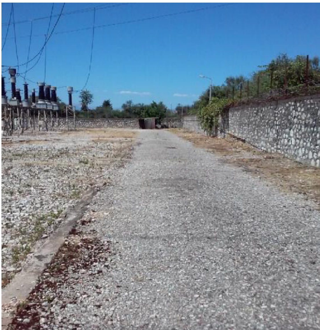
Σχήμα: 2.30. Στην παραπάνω εικόνα εμφανίζεται τμήμα του περιφραγμένου περιβάλλοντα χώρου του υποσταθμού.
