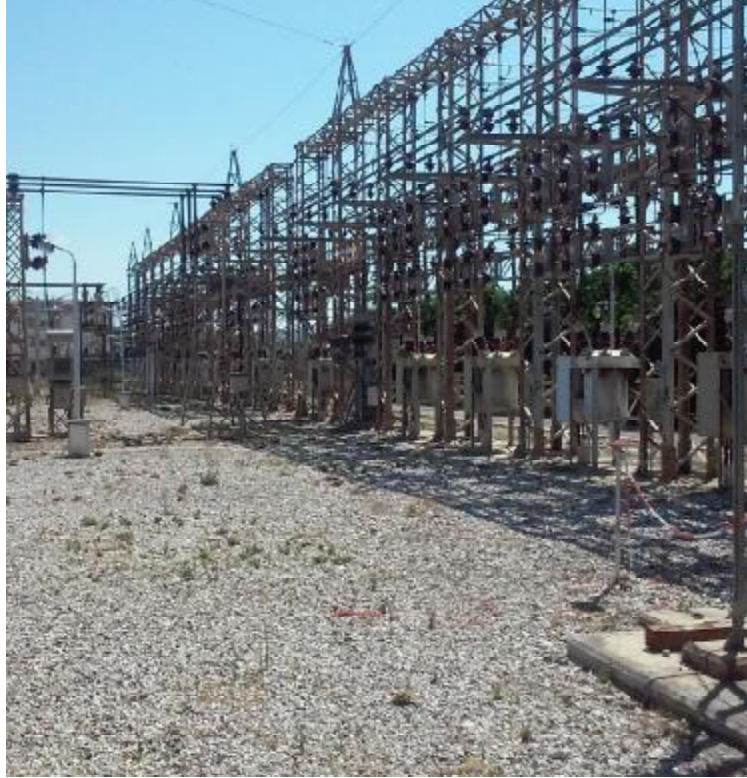
Σχήμα 2.14. Στην παραπάνω εικόνα εμφανίζεται η εγκατάσταση των ζυγών των 20 KV στον υποσταθμό του Πάτρα II .
