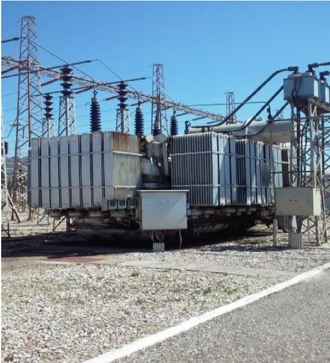
Σχήμα 2.5. Φωτογραφία του Μετασχηματιστή 1 .
