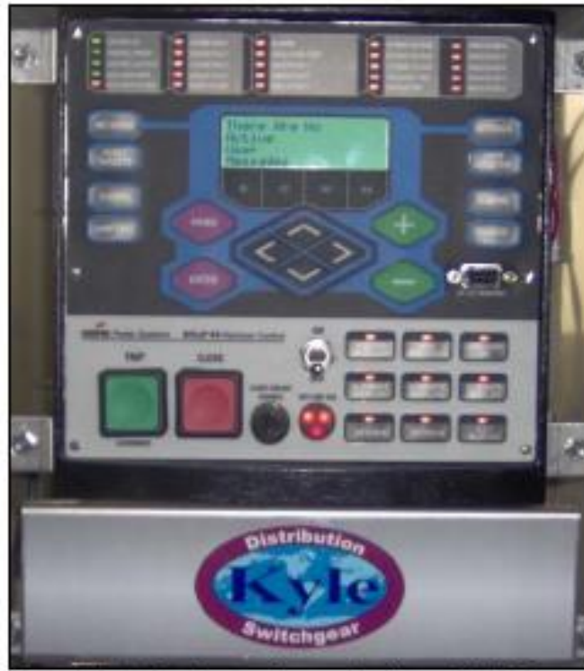
Εικόνα 39 : Πίνακας ελέγχου του Δ/ΑΕ ξηρού τύπου NOVA 27
