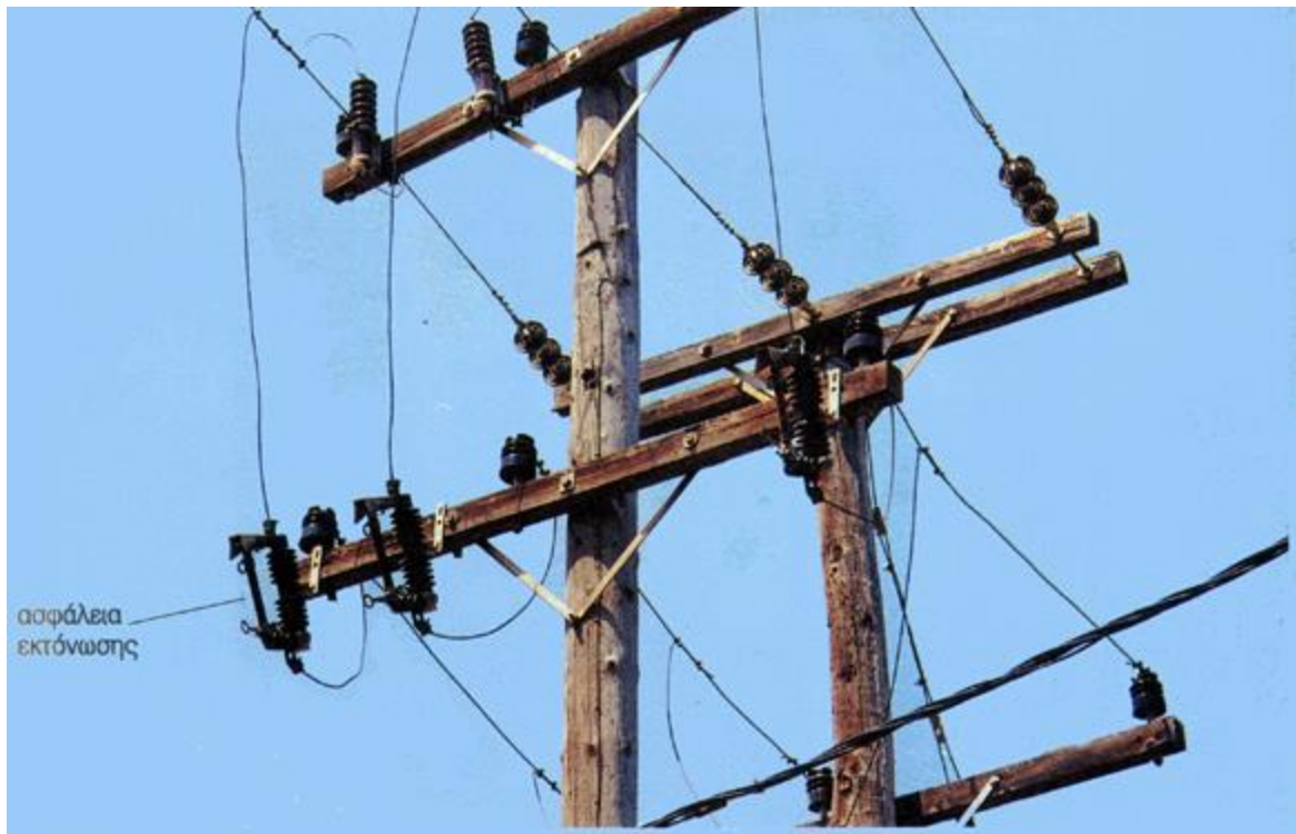
Εικόνα 29: Στύλος μέσης τάσης όπου φαίνονται οι ασφάλειες εκτόνωσης
