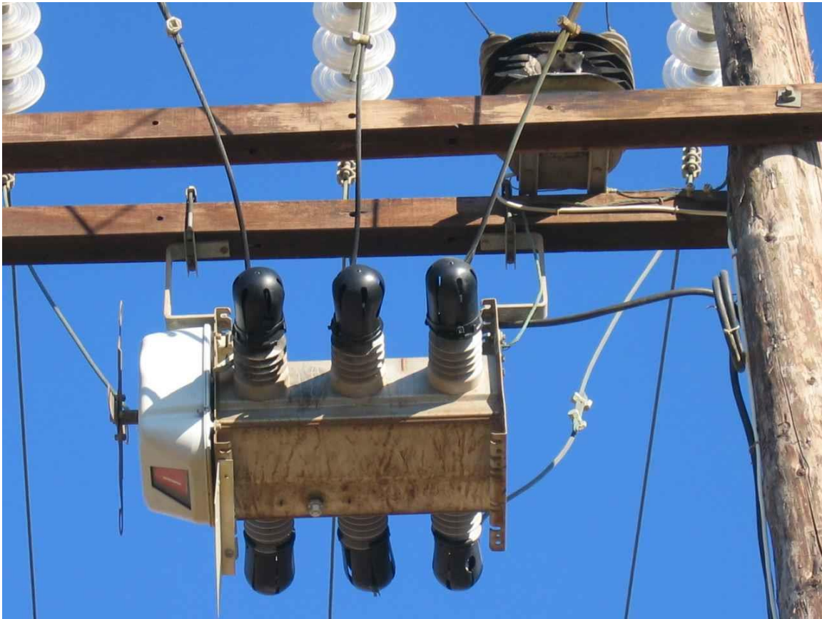
Εικόνα 33: Διακόπτης απομόνωσης μέσης τάσης
