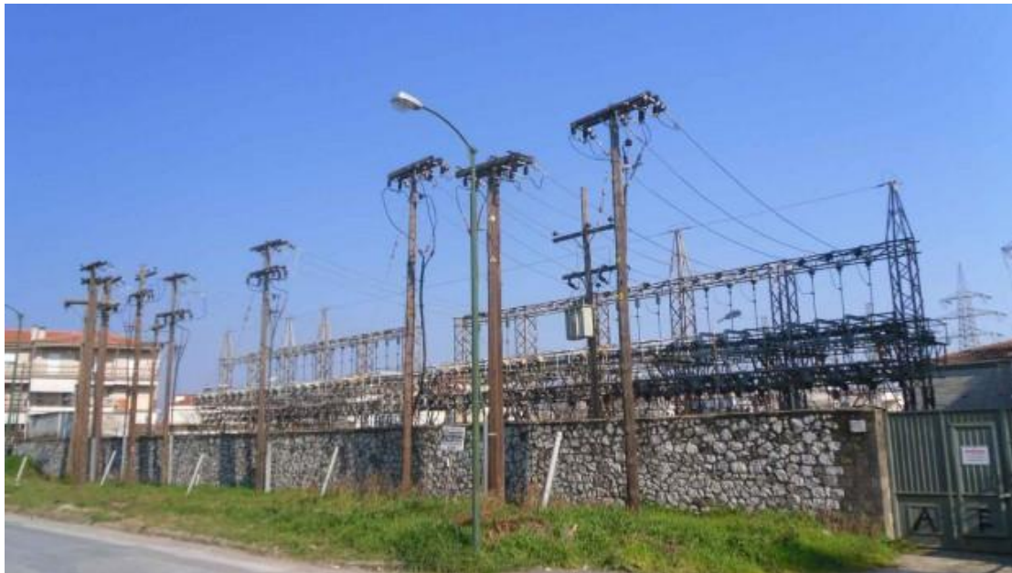
Εικόνα 5: Υποσταθμός καταναλωτή Μέσης Τάσης
