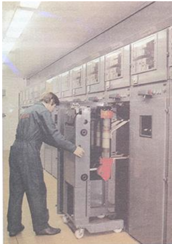
Εικόνα 26: Διακόπτης ισχύος επί φορείου
