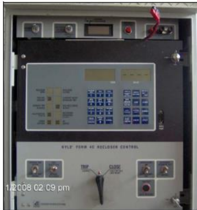
Εικόνα 38 : Πίνακες ελέγχου του Δ/ΑΕ KVFME
