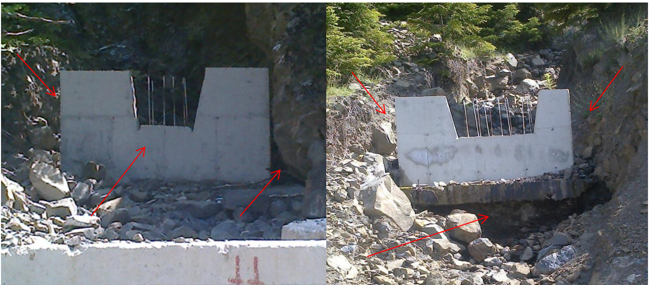
Εικόνα 30 Αστοχία μικρο-αναβαθμού από οπλισμένο σκυρόδεμα
