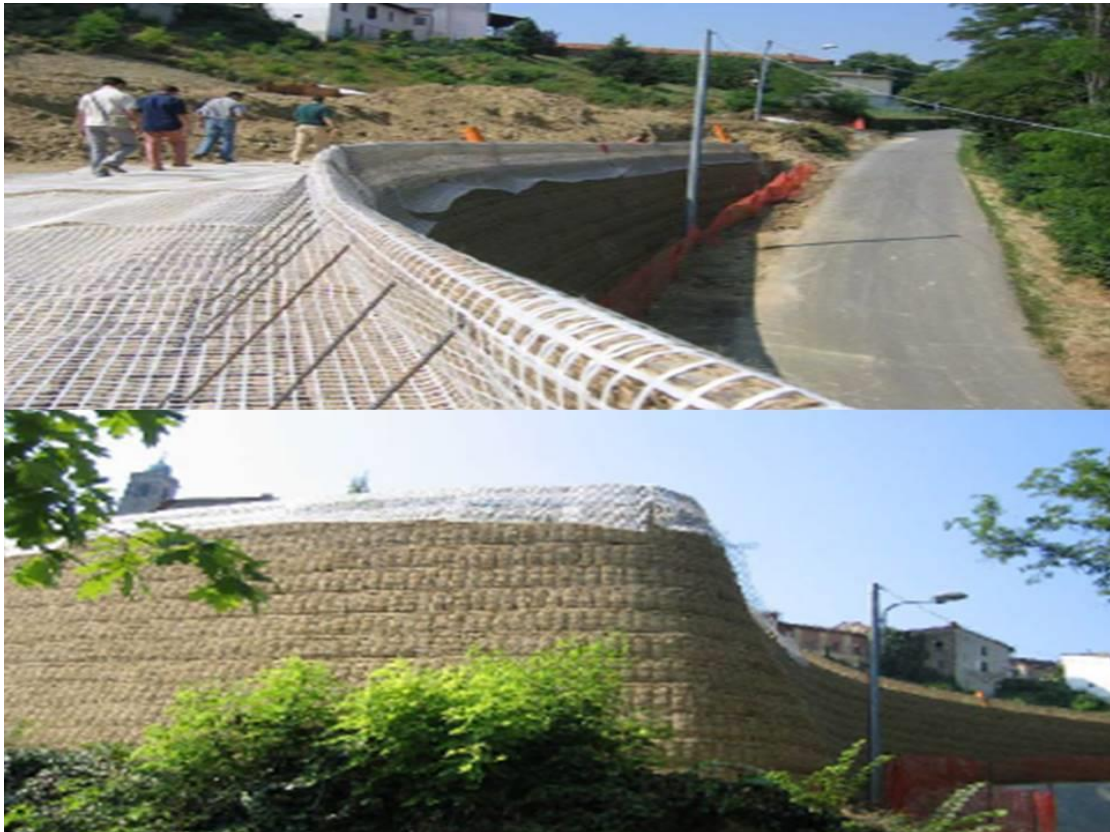
Εικόνα 11. Επάνω: Απεικόνιση τοποθετημένων γεωσυνθετικών, Κάτω: Ενισχυμένο πρανές για την επίτευξη αντιστήριξης ξενοδοχείου
