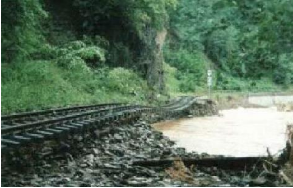
Εικόνα 10. Απεικόνιση περίπτωσης καθίζησης εξαιτίας βαλτωδών εδαφών. Αυτό είχε ως αποτέλεσμα την καταστροφή της ράγας που διέρχεται το τρένο
