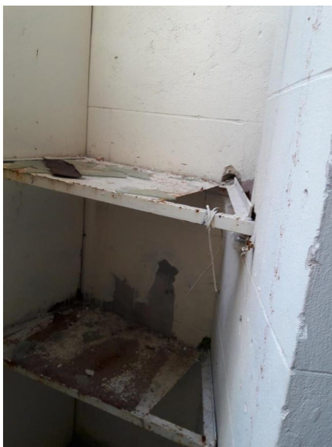
Εικόνα 135. Λεπτομέρεια χώρου ΗΕ
