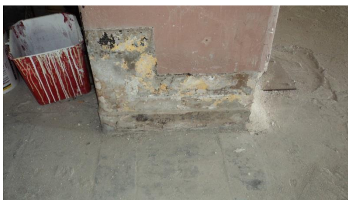
Εικόνα 12. Ένδειξη ύπαρξης ριχτιών στην συμβολή χώρων A-K
