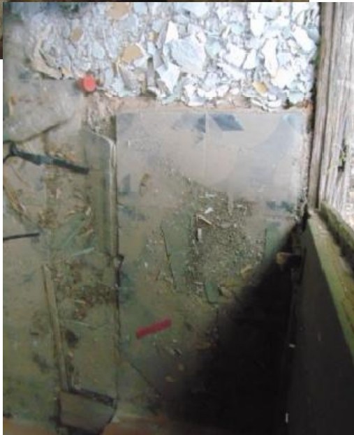
Εικόνα 84 Φθορά σανιδωμάτων ξύλινου δαπέδου και σπασίματα τσιμεντοπλακιδίων αντιστοίχως.
