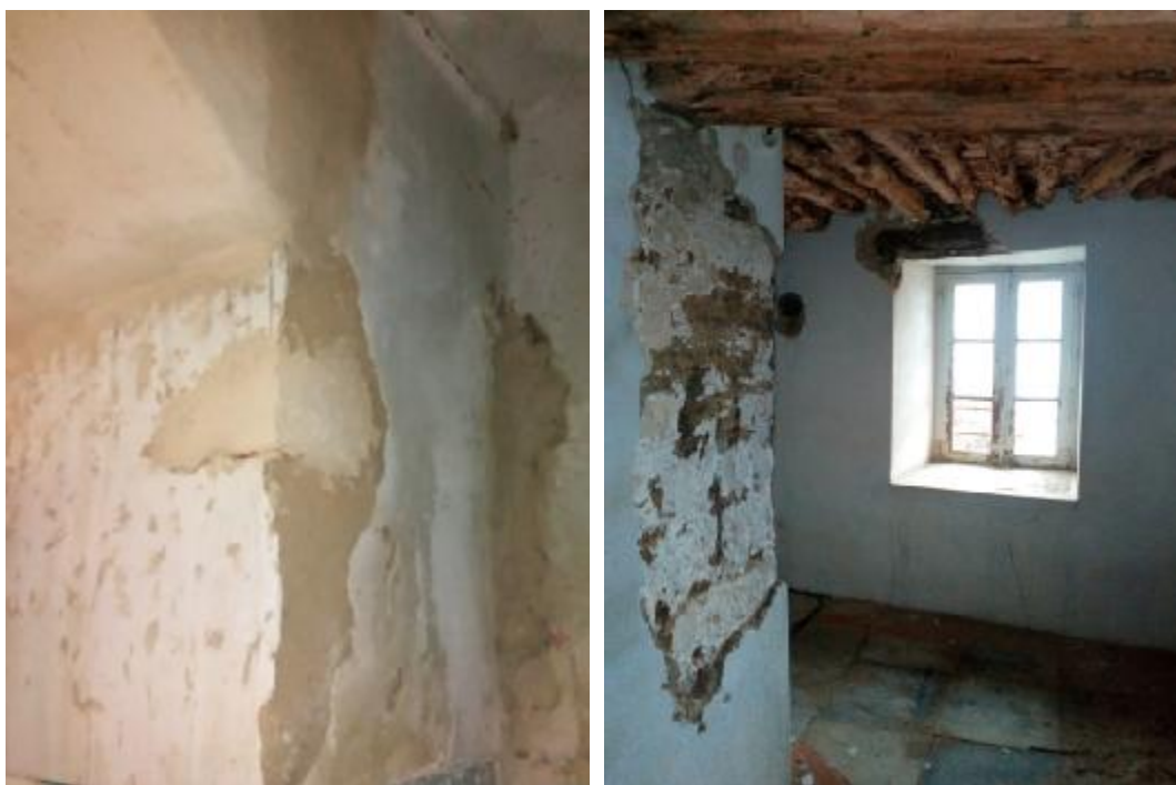
Εικόνα 81 Αποκόλληση επιχρίσματος τοιχοποιίας.
