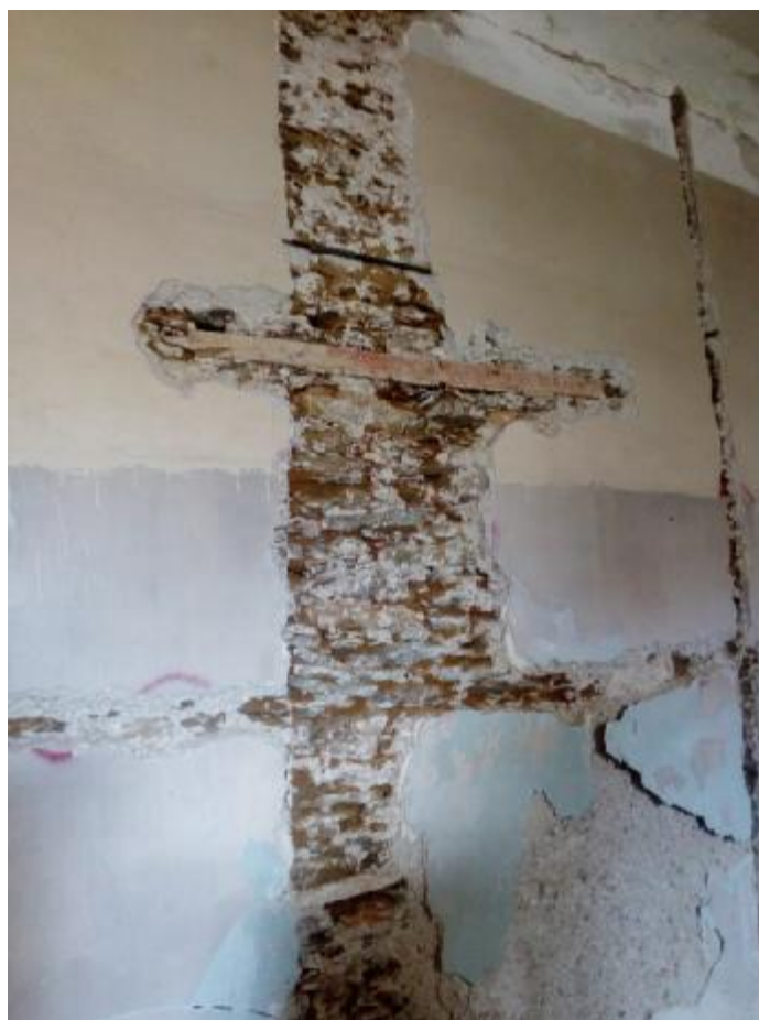
Εικόνα 18 Τομή καθ' ύψος της φέρουσας τοιχοποιίας για μελέτη της λιθοδομής, στον χώρο του ισογείου.
