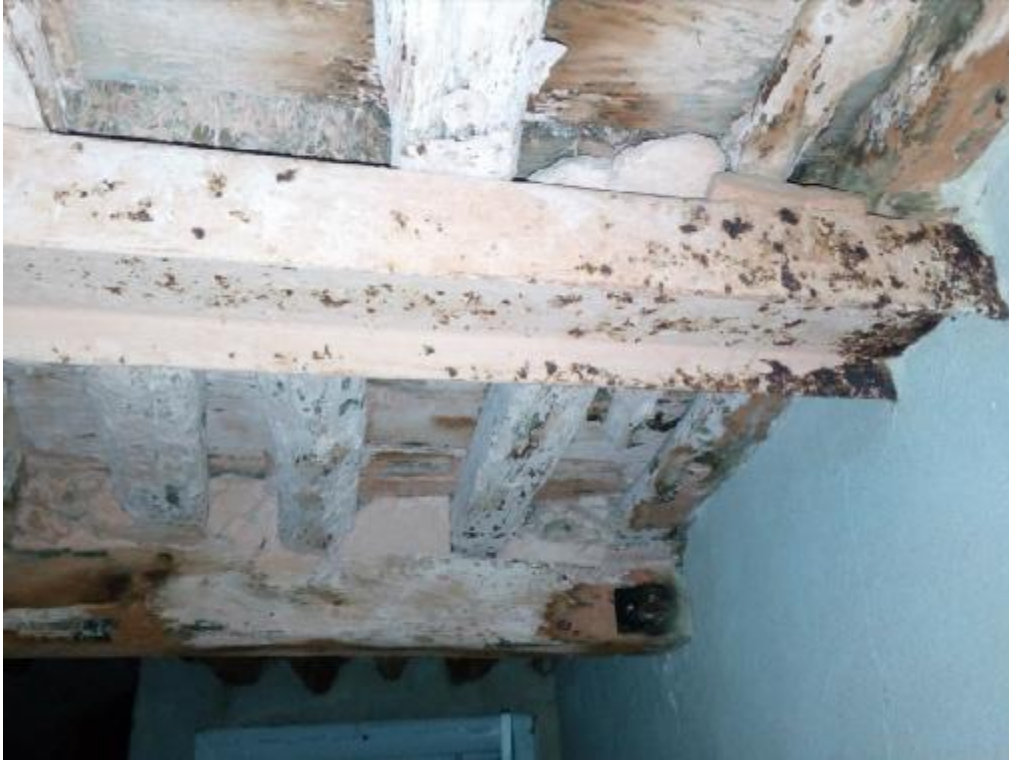
Εικόνα 92 Οξείδωση μεταλλικών στοιχείων.
