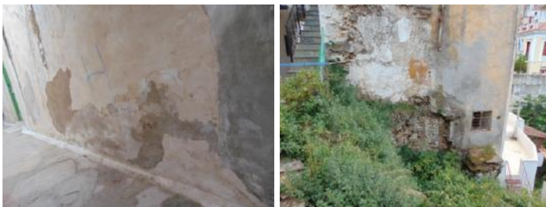
Εικόνα 73 Φουσκώματα λόγω υγρασίας και αποκολλήσεις επιχρίσματος στις όψεις.
