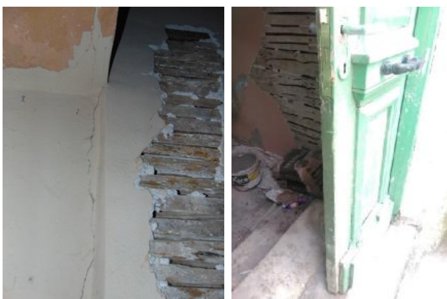
Εικόνα 74 Αποκόλληση επιχρίσματος λόγω υγρασίας, εμφάνιση ξύλινου σκελετού μπαγδατί.
