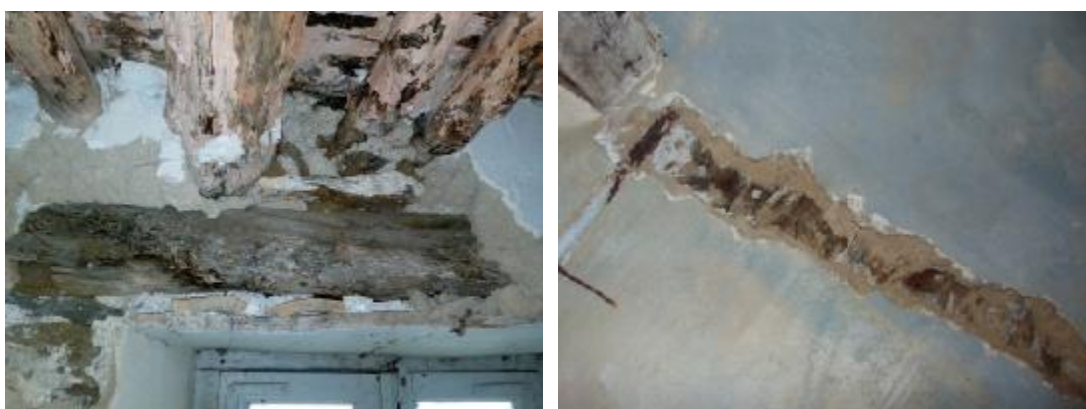
Εικόνα 72 Αποκόλληση επιχρίσματος εις βάθος στο ημιυπόγειο.
