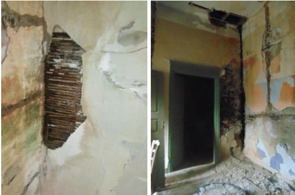
Εικόνα 87 Οροφή ισογείου τμηματική κατάρρευση μπαγδατόπηχων.
