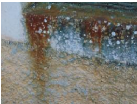
Εικόνα 78 Εμφάνιση επανθίματος στο επίχρισμα του στηθαίου.
