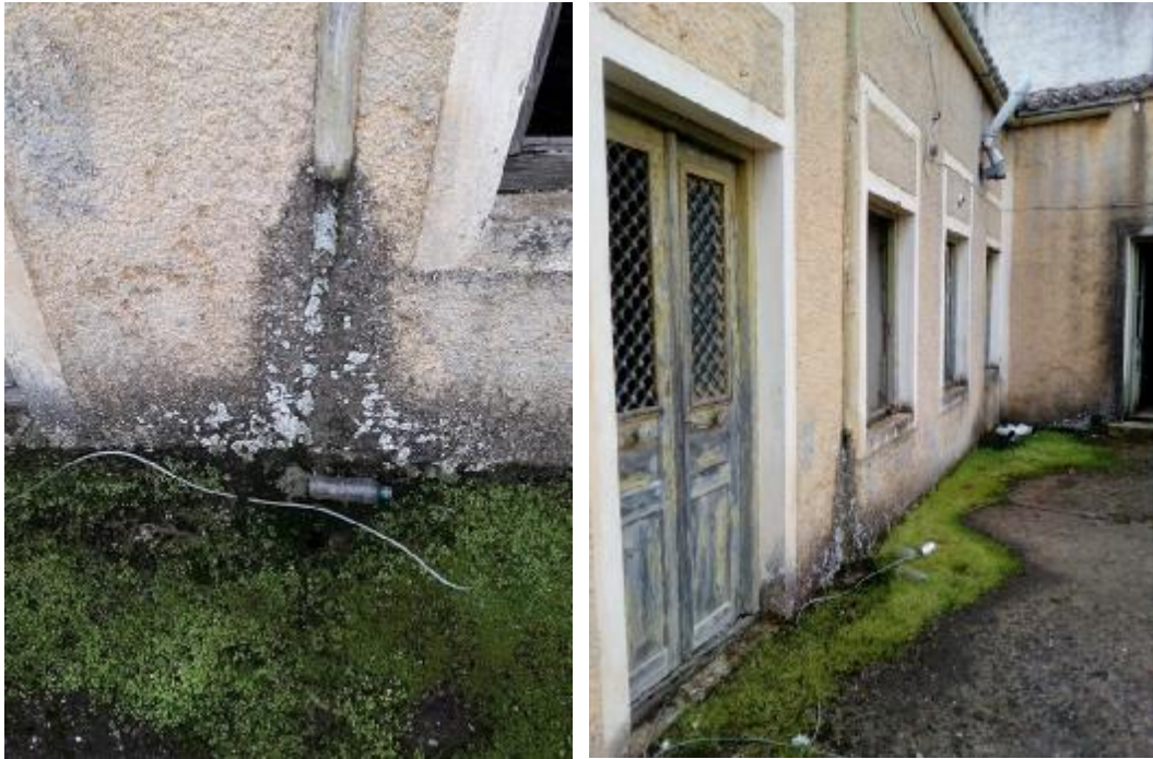
Εικόνα 85 Ανάπτυξη μικροοργανισμών στην πλάκα σκυροδέματος της βεράντας.
