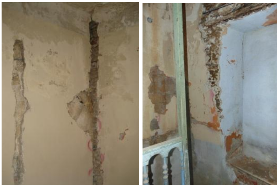
Εικόνα 68 Αποκόλληση επιχρίσματος, φούσκωμα τοιχοποιίας στο ισόγειο.
