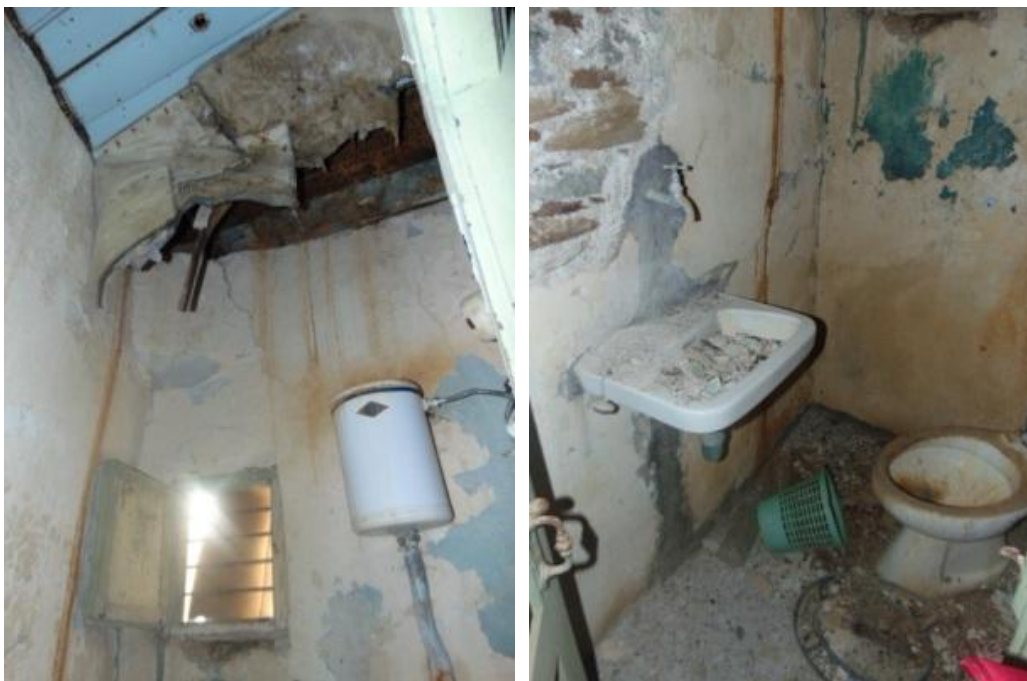
Εικόνα 63 Χώρος wc στο ισόγειο-υδραυλικές εγκαταστάσεις.
