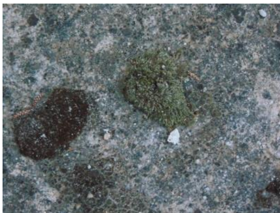
Εικόνα 76 Μικροοργανισμοί στο επίχρισμα της νοτιοδυτικής όψης.
