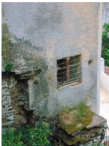
Εικόνα 79 Πεταλίδες στη βορειοανατολική όψη.
