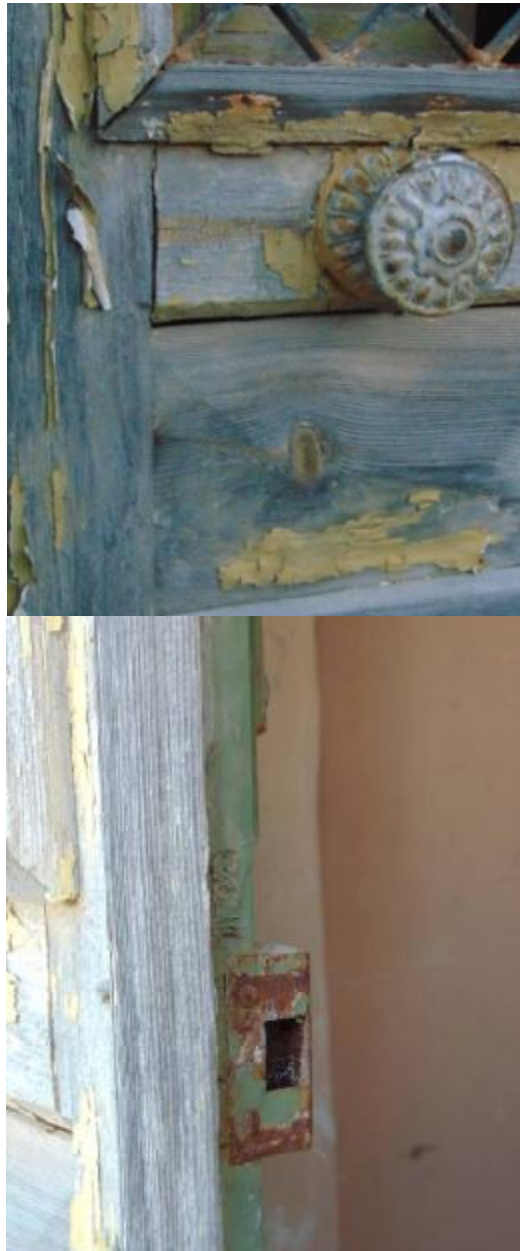
Εικόνα 96 Οξειδωση μεταλλικών στοιχείων και αποφλοίωση χρώματος ξύλινου κουφώματος.
