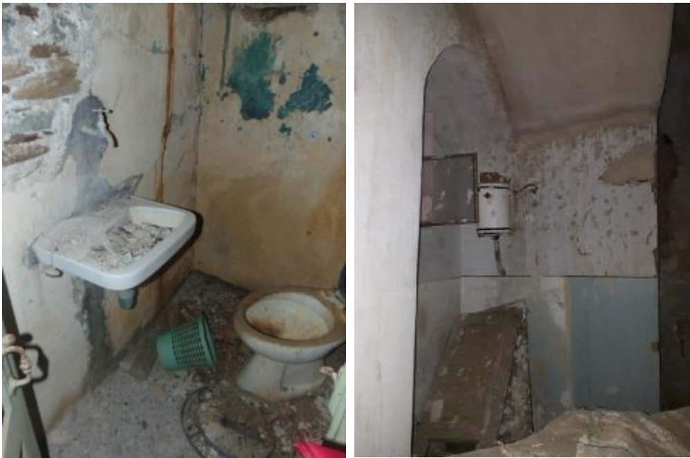
Εικόνα 98 Εγκατάλειψη υδραυλικής εγκατάστασης.
