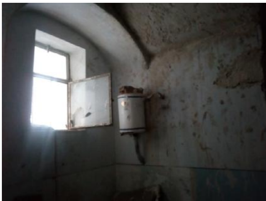
Εικόνα 64 Υδραυλική εγκατάσταση θερμοσίφωνα στο κουζινάκι.
