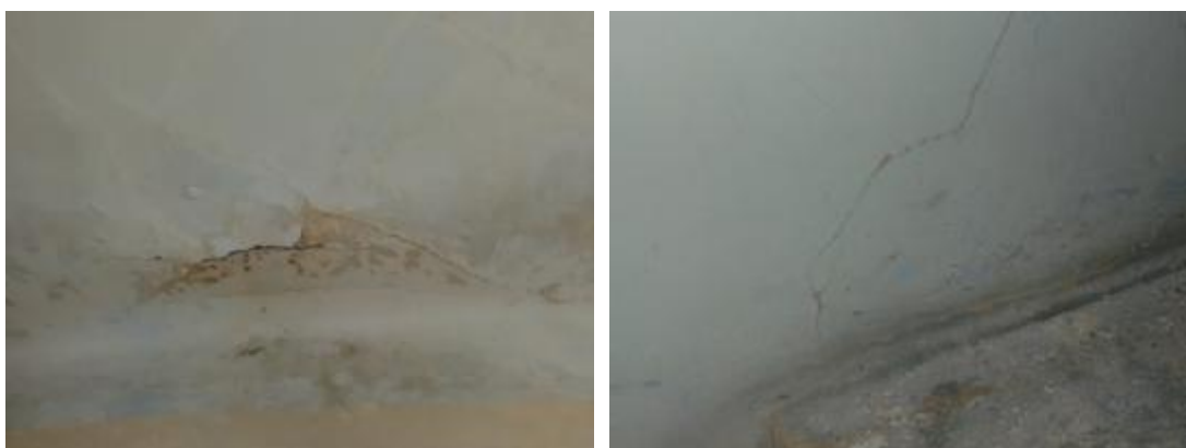
Εικόνα 71 Μικρορωγμές και φούσκωμα τοιχοποιίας στο ισόγειο.
