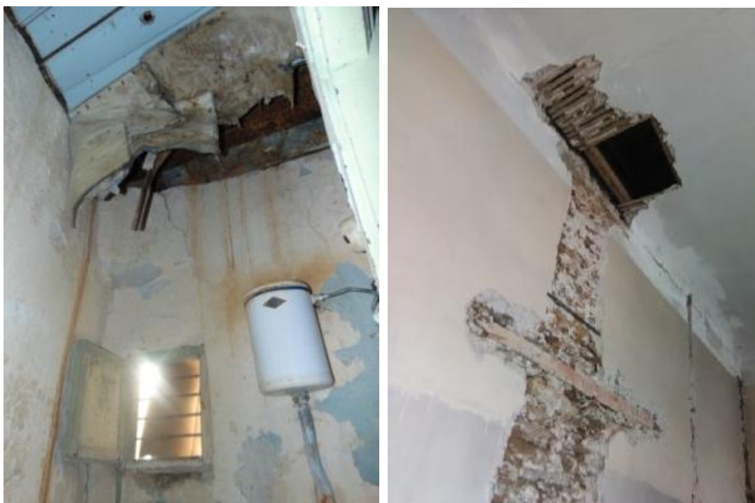
Εικόνα 70 Αλλοιώσεις οριζόντιου φέροντα οργανισμού από υγρασία λόγω έλλειψης διαφραγματικής λειτουργίας της στέγης.
