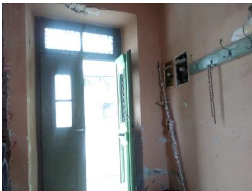
Εικόνα 65 Ηλεκτρική εγκατάσταση-ηλεκτρικός πίνακας.
