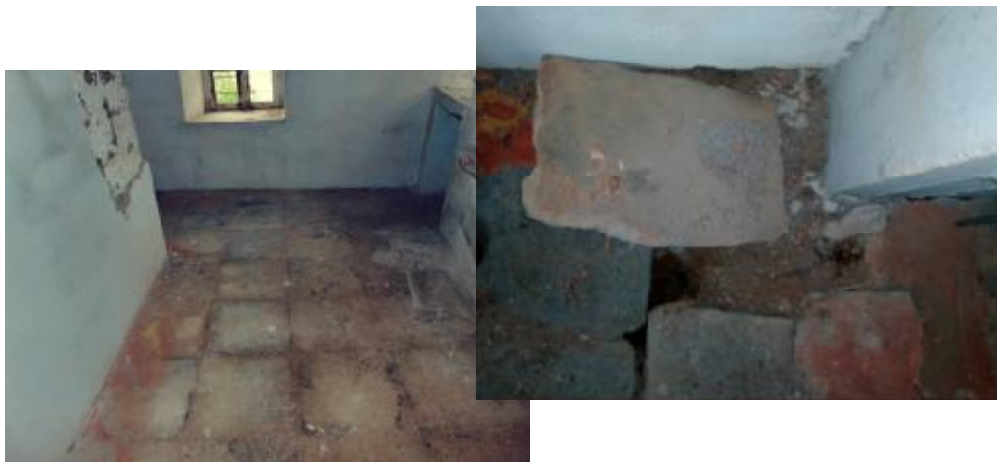
Εικόνα 86 Σχιστόπλακες ημιυπογείου, εμφάνιση φυσικής φθοράς και μικρών σπασιμάτων.
