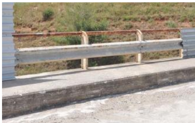
Σχήμα 3- 16 Υφιστάμενο στηθαίο ασφαλείας (προς αντικατάσταση).
