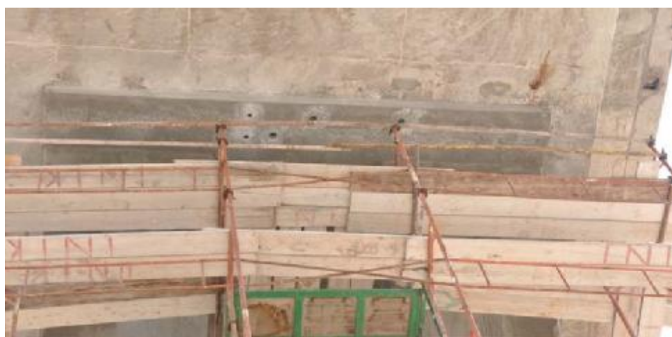
Σχήμα 3- 11 Όψη του εκτοξευόμενου σκυροδέμα στην βάση της διαδοκίδας (άνοψη). Διακρίνονται οι θέσεις όπου έγινε λήψη πυρήνων για τον έλεγχο αντοχής του σκυροδέματος.
