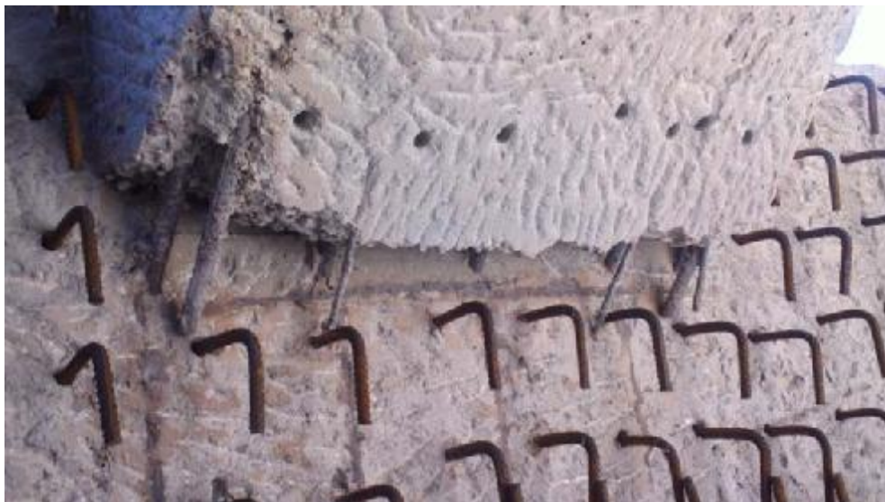
Σχήμα 3- 12 Προετοιμασία πέλδων για σκυροδέτηση του επιπλέον πάχους τους (τοποθέτηση οπλισμού σύνδεσης υφιστάμενου με νέο σκυρόδεμα).
