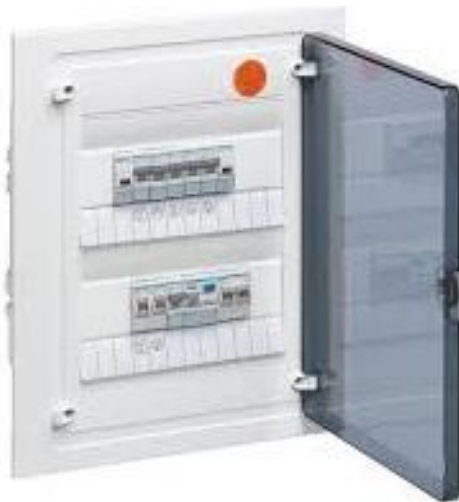
Εικόνα 8 : Γενικός πίνακας εσωτερικής εγκατάστασης
