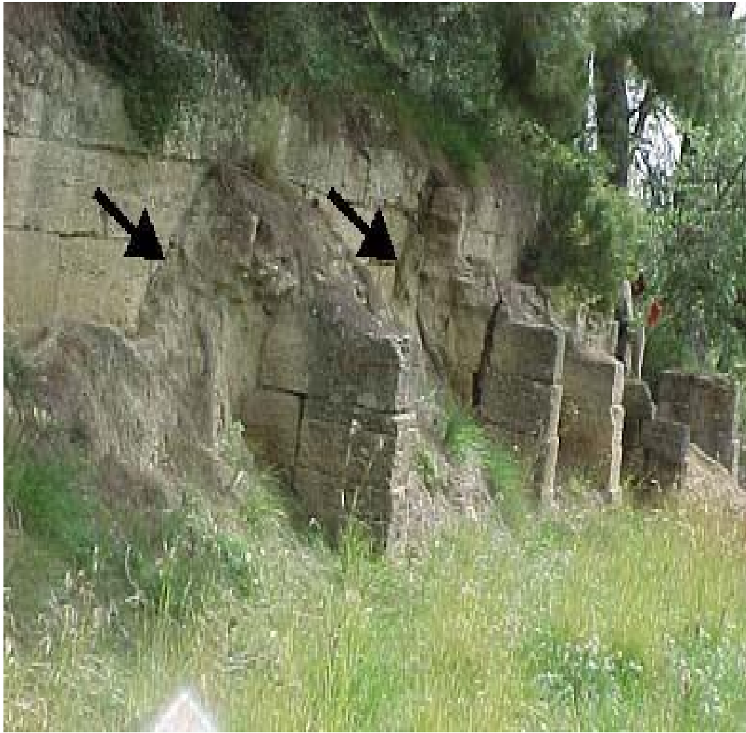
Αστοχία τοίχου αντιστήριξης με αντιρήδες λόγω ανατροπής
