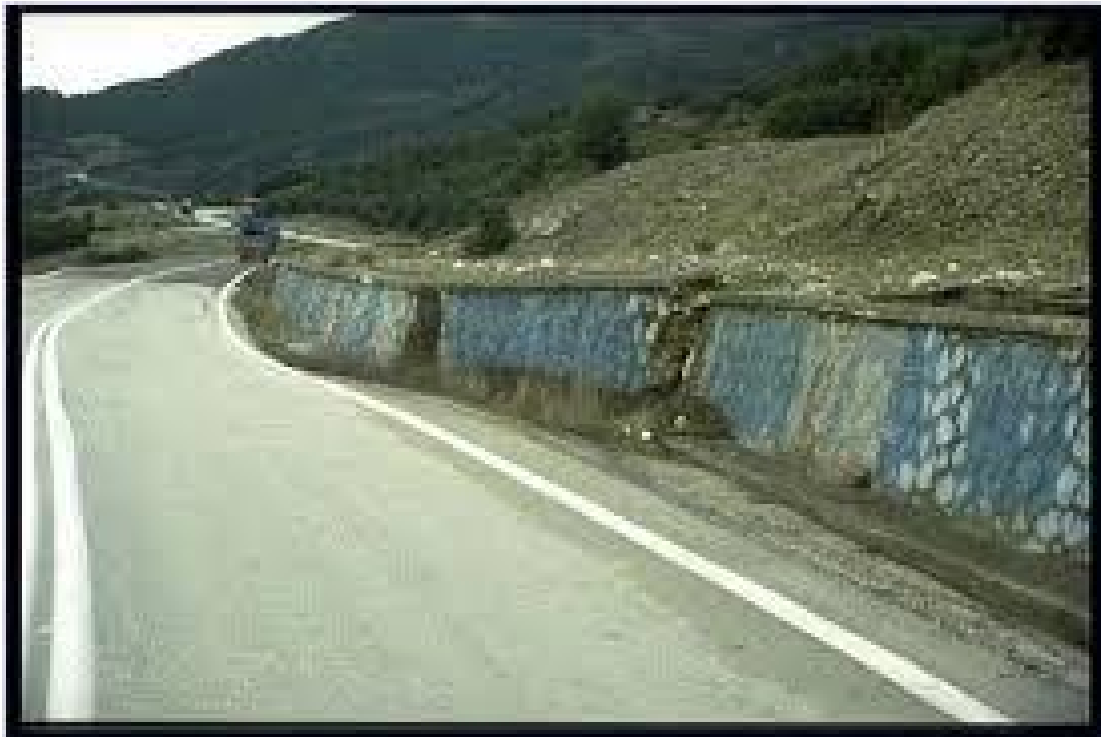
Αστοχία τοίχου βαρύτητας
