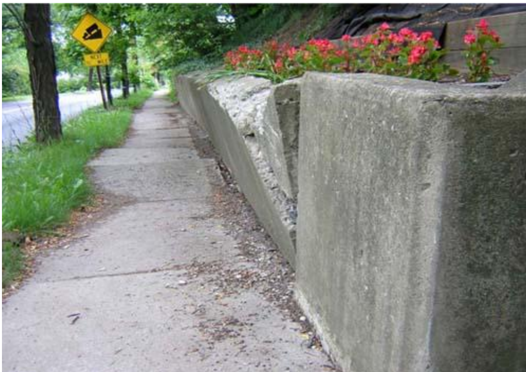
Αστοχία τοίχου αντιστήριξης μορφής προβόλου
