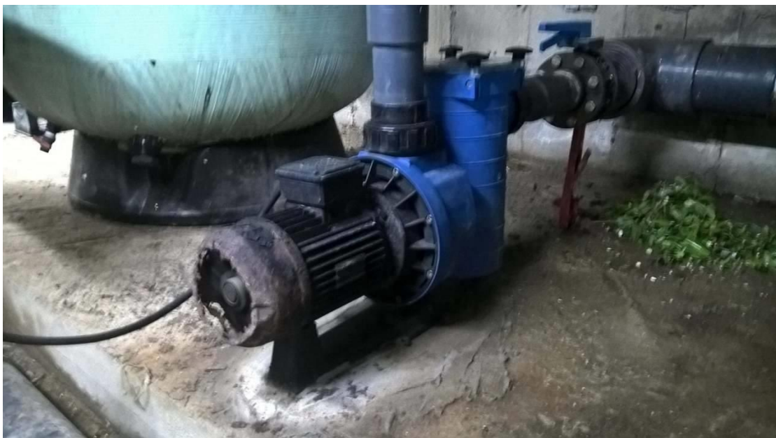
Εικόνα 12: Μηχανολογικός εξοπλισμός (ηλεκτροκινητήρας-αντλία νερού 1.3 kWh)
