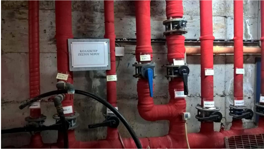
Εικόνα 17: Κολλεκτέρ ζεστού νερού από εδώ διοχετεύεται το νερό στην θερμαινόμενη πισίνα
