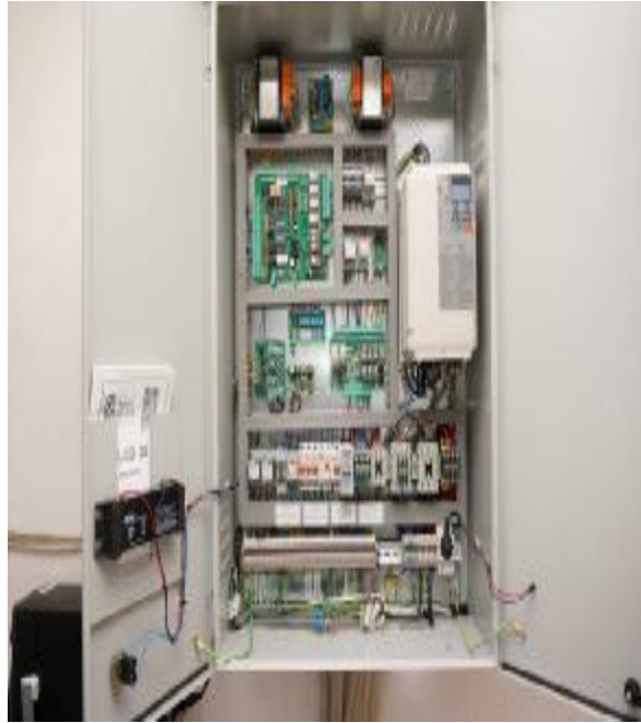
Εικόνα 14: Πίνακας ανελκυστήρα με Inverter
