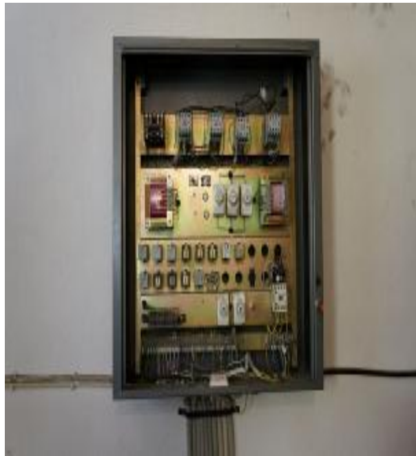
Εικόνα 13: Συμβατικός πίνακας ανελκυστήρα.
