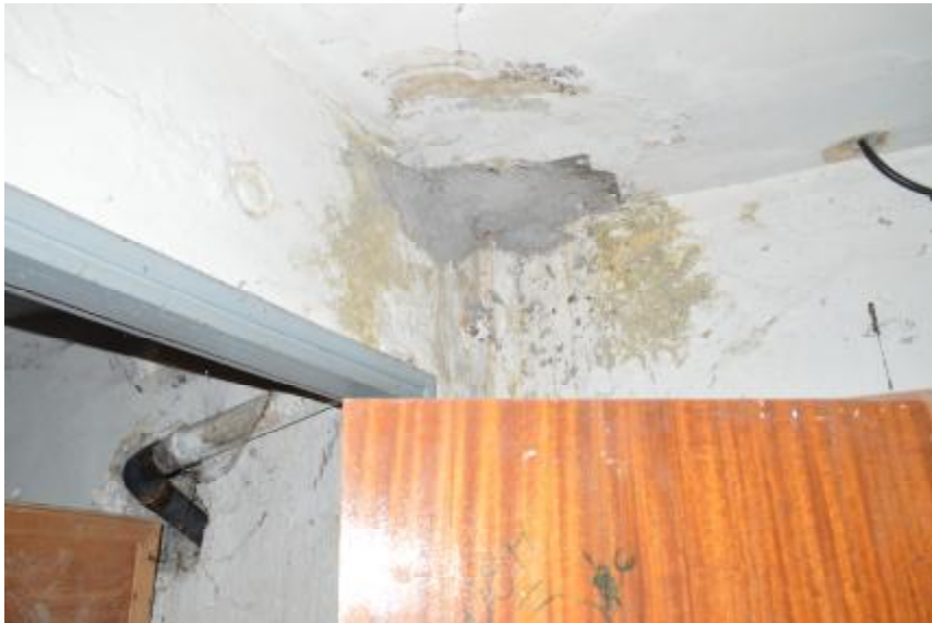
Εικόνα 69. Σημάδια υγρασίας στο ισόγειο
