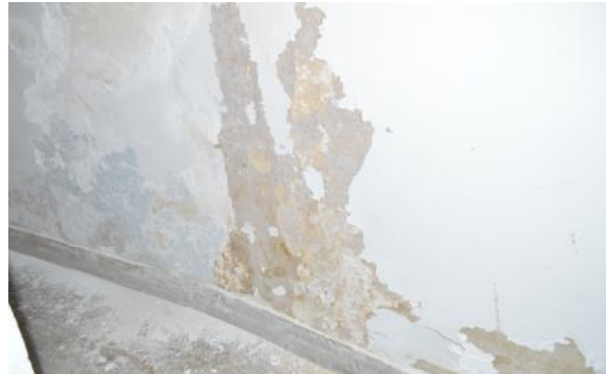
Εικόνα 70. Σημάδια υγρασίας στο ισόγειο
