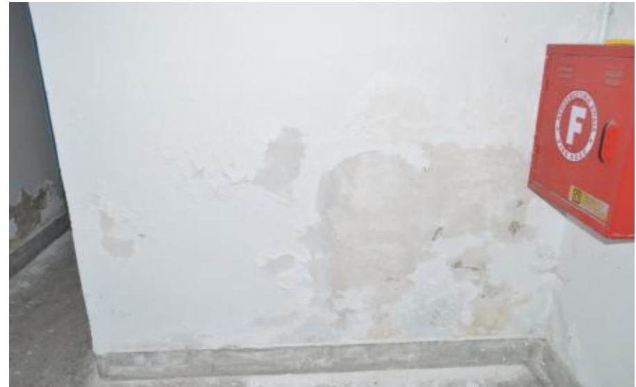
Εικόνα 68. Υγρασία στο χώρο του ισόγειου
