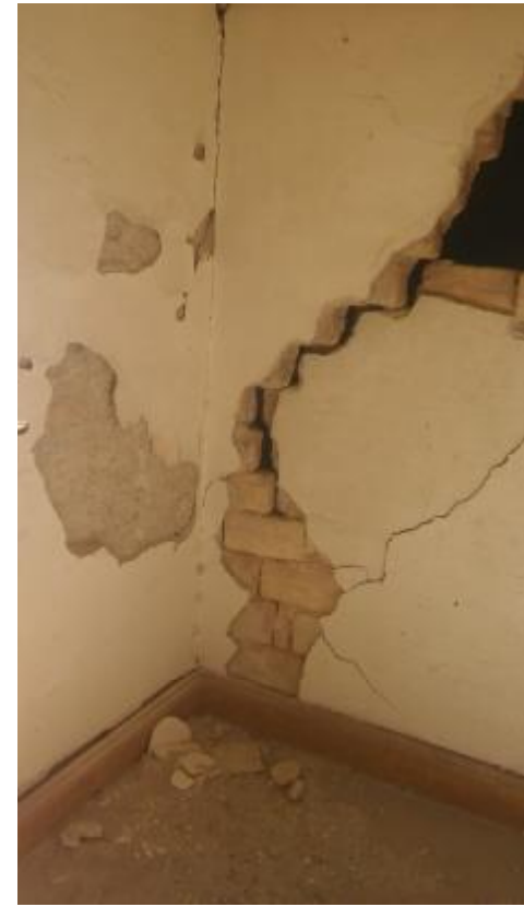
Εικόνα 81. Αποκόλληση τοιχοποιίας, ρωγμές
