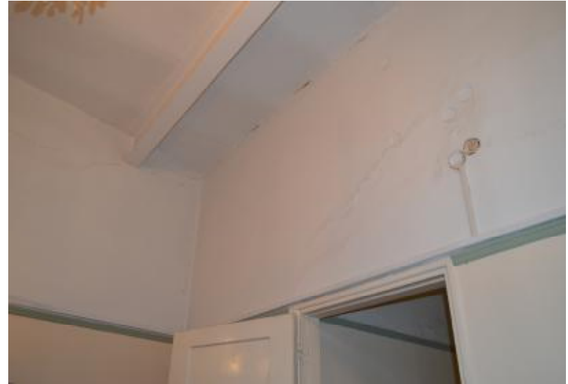
Εικόνα 72. Ρωγμές σε εσωτερική τοιχοποιία
