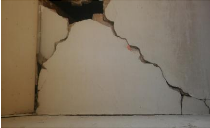
Εικόνα 82. Αποκόλληση τοιχοποιίας, ρωγμές
