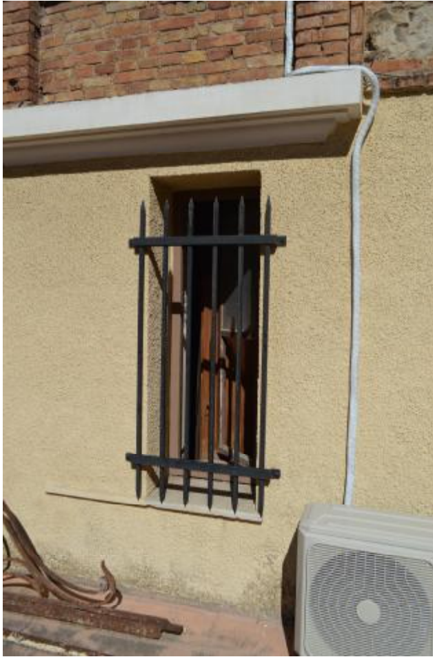
Εικόνα 61. Ανοιγμα κλεισμένο κατά πλάτος
