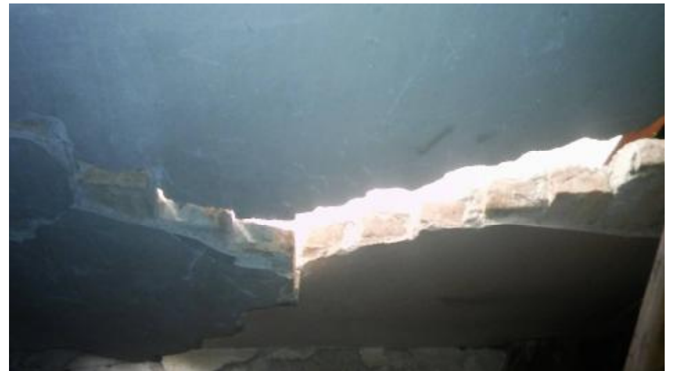
Εικόνα 85. Αποκόλληση τοιχοποιίας, ρωγμές
