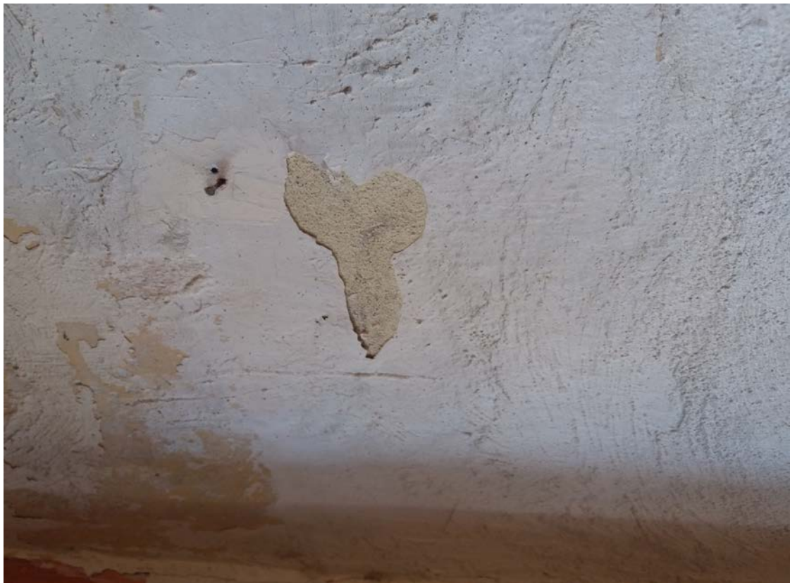
Εικόνα 38. Υγρασία στη νότια τοιχοποιία, στο κλιμακοστάσιο.
