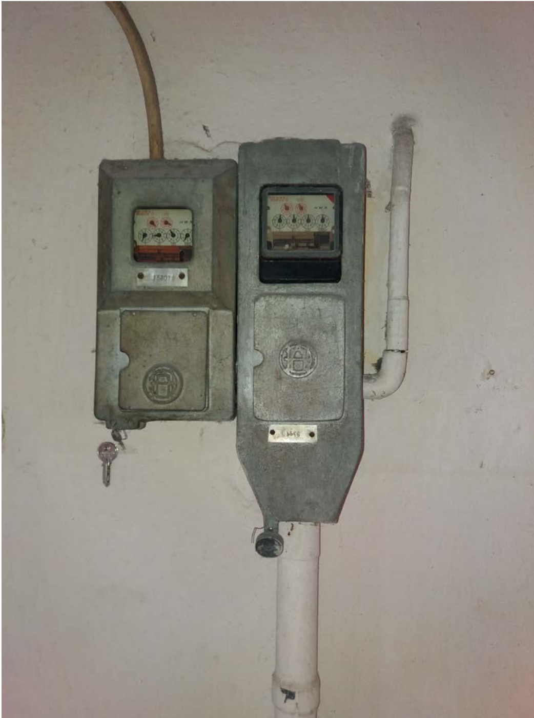
Εικόνα 49. Παροχή ηλεκτρικού ρεύματος
