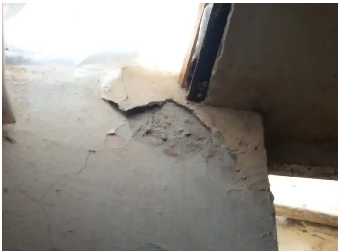
Εικόνα 55. Αποκόλληση επιχρίσματος. Νότια τοιχοποιία (δωμάτιο 100).
