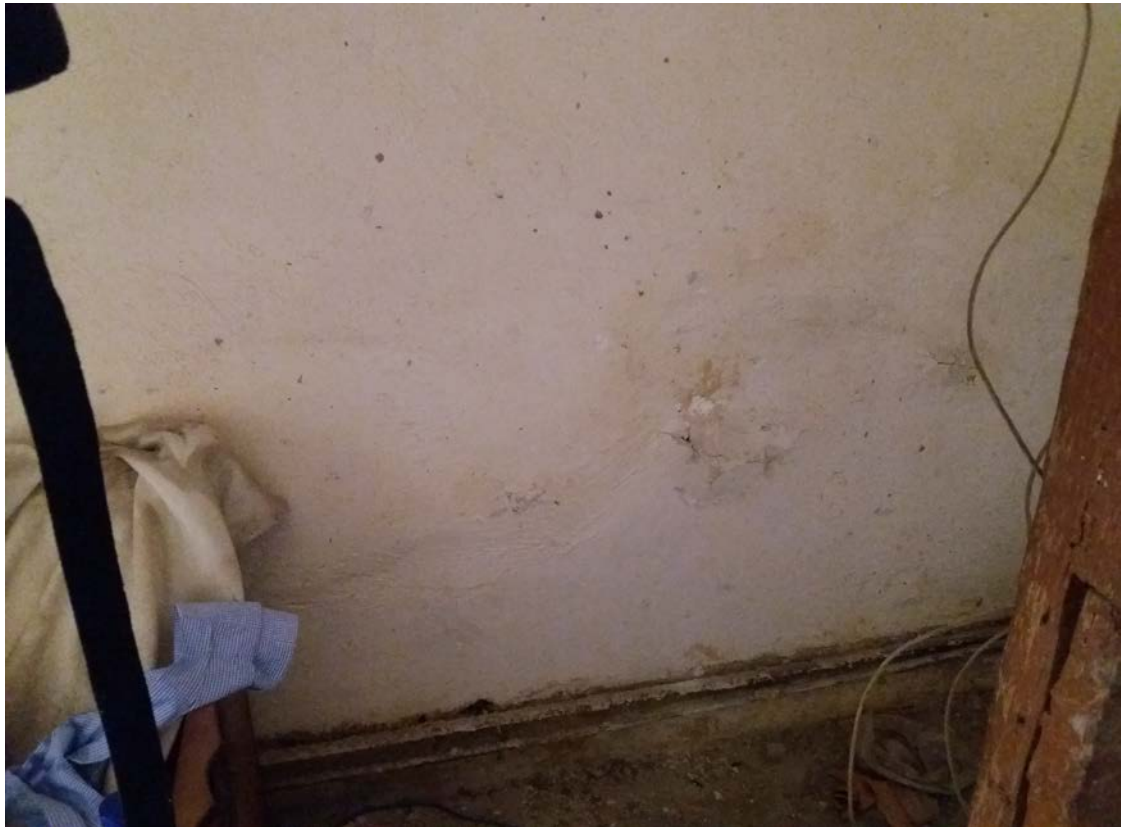
Εικόνα 41. Υγρασία στη νότια τοιχοποιία, στο κλιμακοστάσιο.
