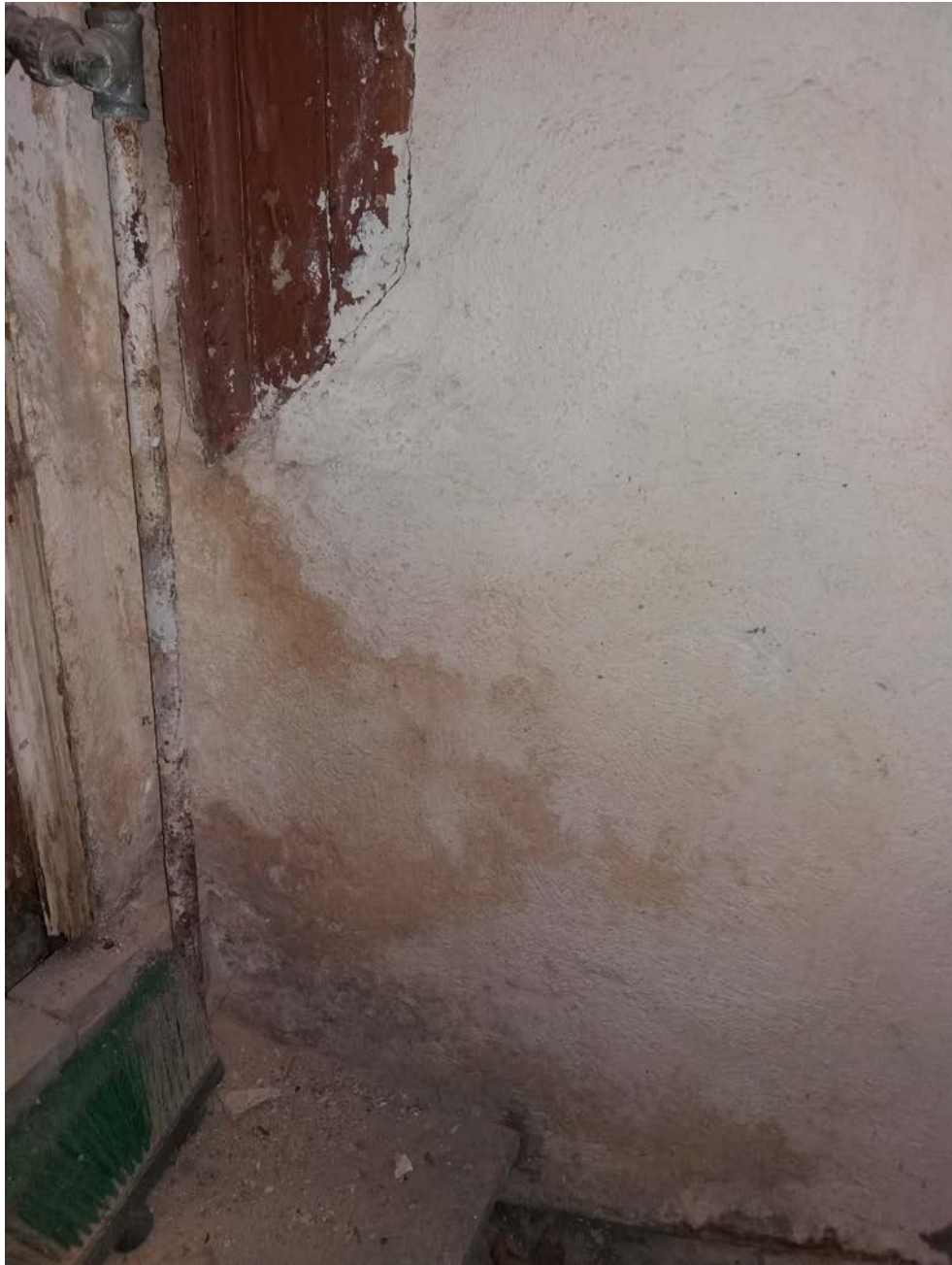
Εικόνα 48. Ανερχόμενη υγρασία στη Βορινή τοιχοποιία του διαδρόμου.
