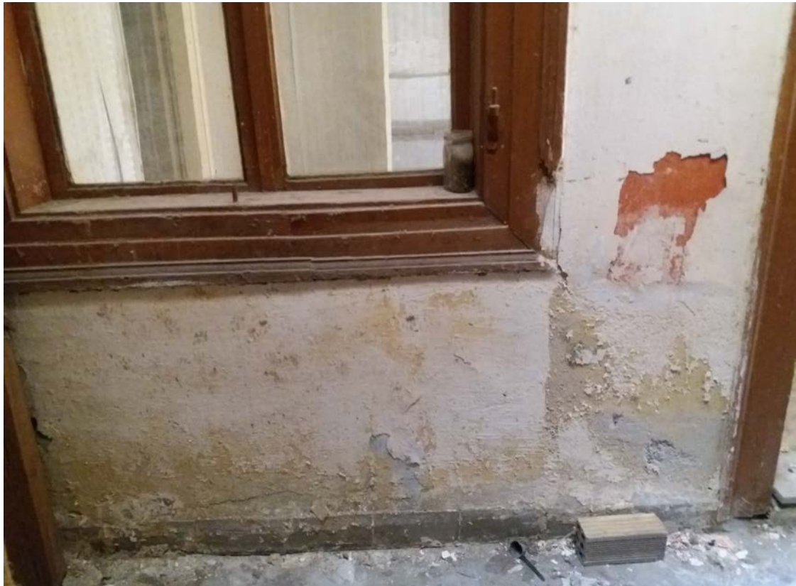
Εικόνα 47. Ανερχόμενη υγρασία στη Βορινή τοιχοποιία του διαδρόμου.
