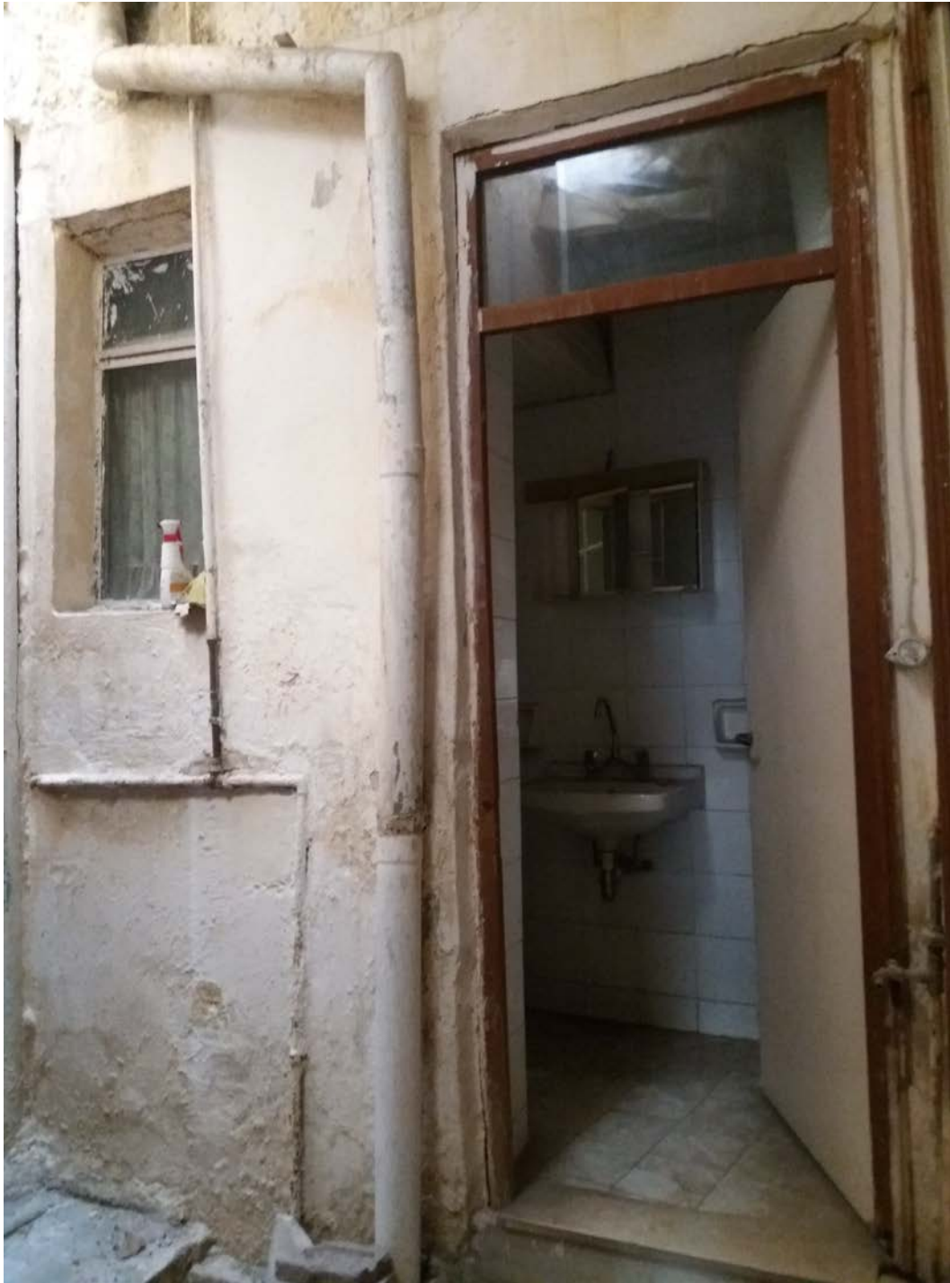
Εικόνα 42. Υγρασία στη τοιχοποιία του λουτρού.
