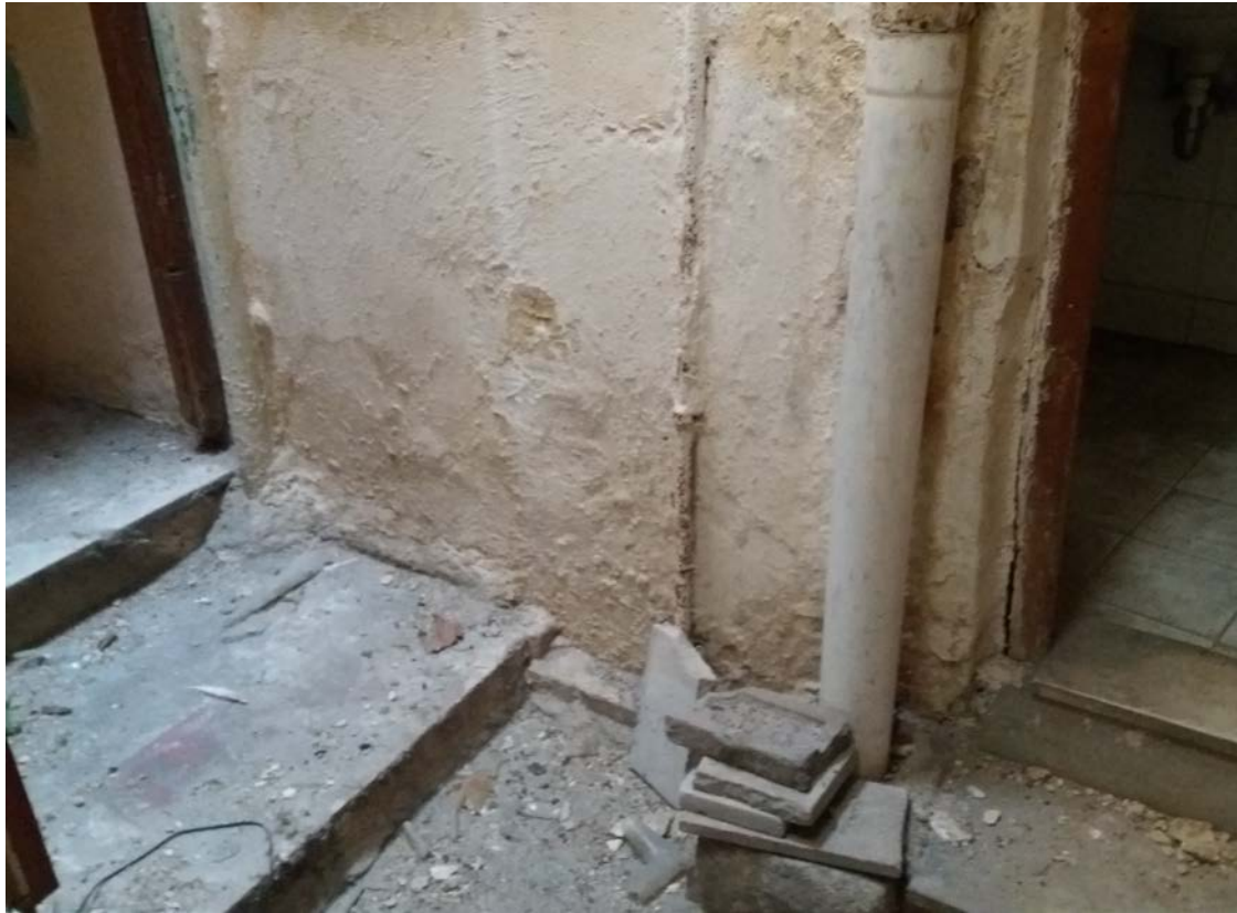
Εικόνα 43. Υγρασία στη τοιχοποιία του λουτρού.
