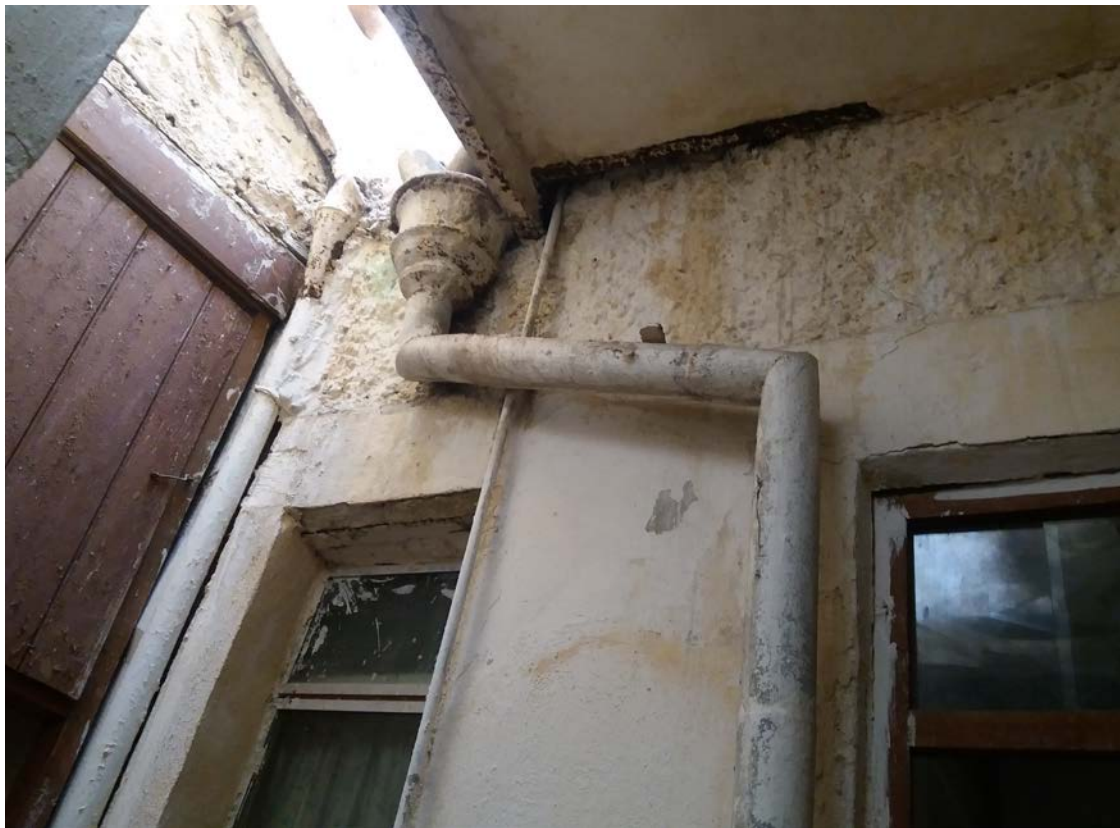
Εικόνα 44. Υγρασία στη τοιχοποιία του λουτρού.
