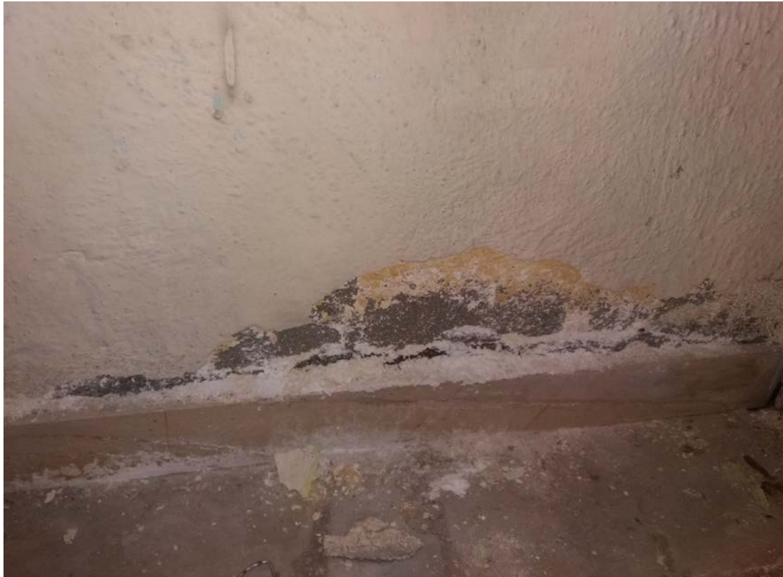
Εικ. 69. Υγρασία στην βόρεια τοιχοποιία του χώρου 130.
