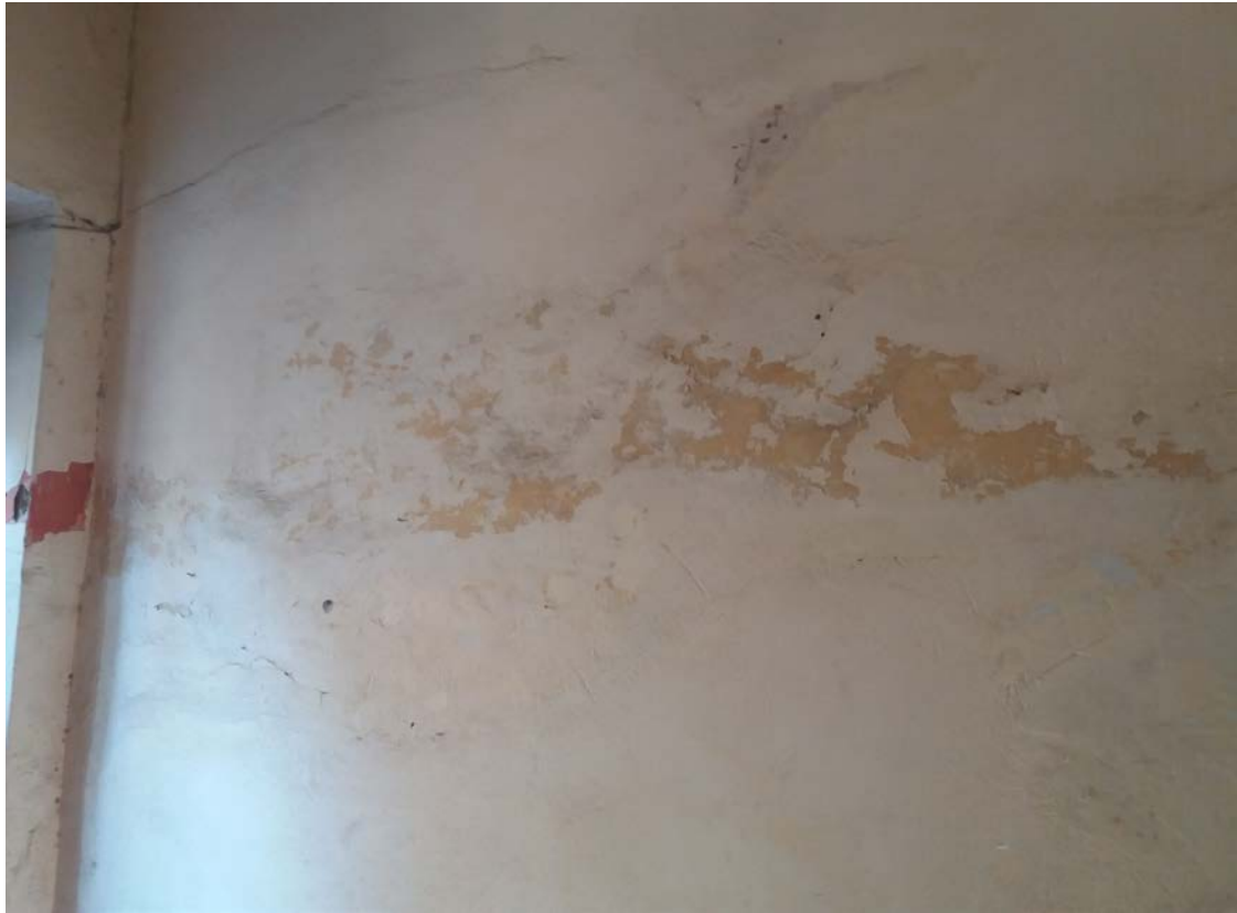
Εικόνα 40. Υγρασία στη νότια τοιχοποιία, στο κλιμακοστάσιο.
