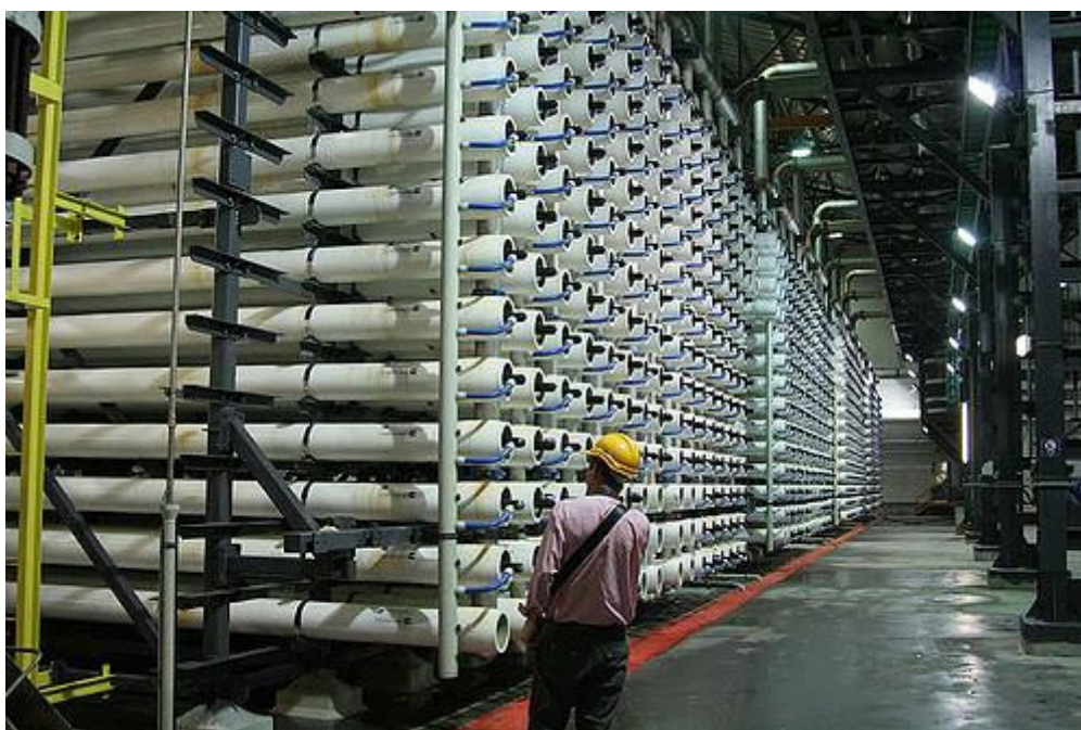
Εικόνα 1.26: Συστοιχίες αγωγών πίεσης της μονάδας αφαλάτωσης του Ashkelon (Ισραήλ)
