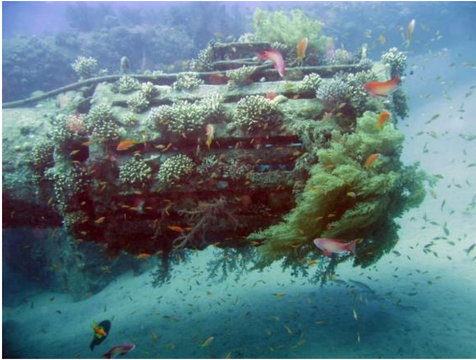
Εικόνα 3.1: Αγωγός εισροής θαλασσινού νερού της μονάδας αφαλάτωσης της Nuweiba (Αίγυπτος)
