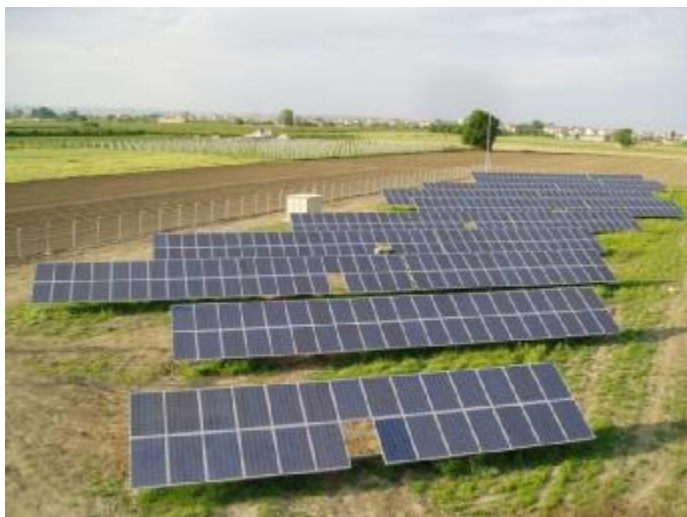
Εικόνα 36 Σταθερό φωτοβολταϊκό πάρκο 150KW στην Νέα Έφεσο Κατερίνης
