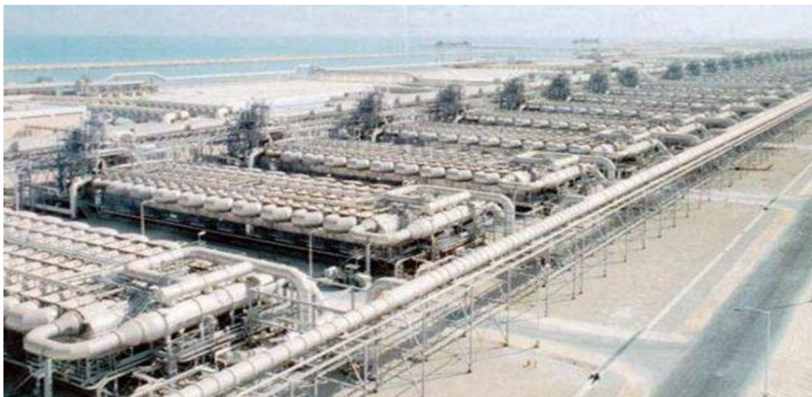
Εικόνα 7: Εγκατάσταση πολυβάθμιας εκτόνωσης στην Σαουδική Αραβία. [Πηγή: Συσκάκη, 2013]
