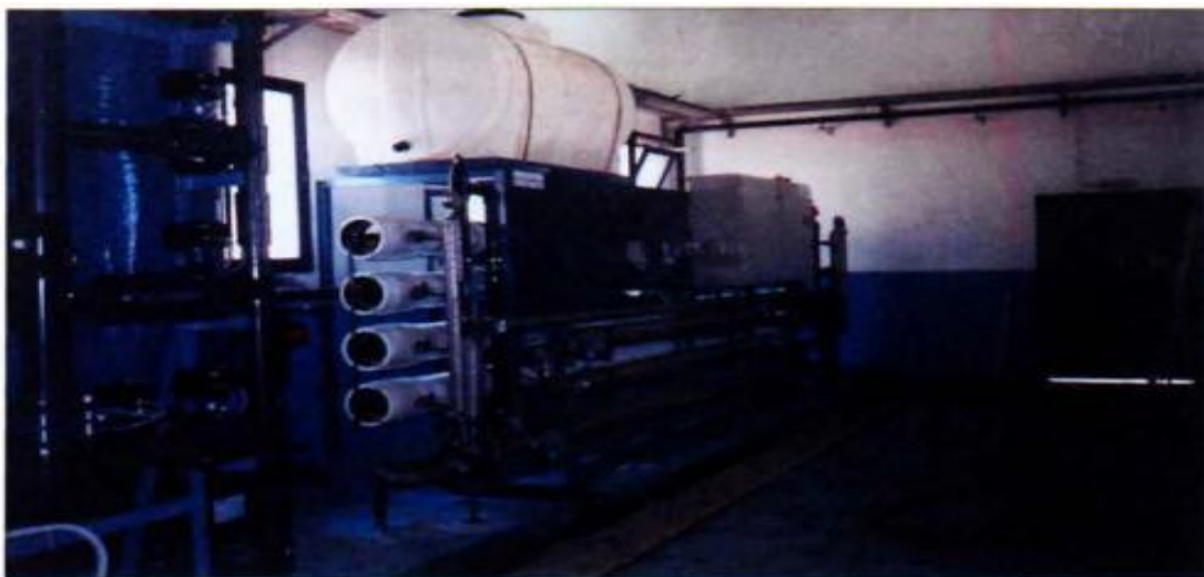
Εικόνα 9: Μονάδα αντίστροφης ώσμωσης στη Νίσυρο. [Πηγή: Ψωμόπουλος και Χριστοφής, 2011]
