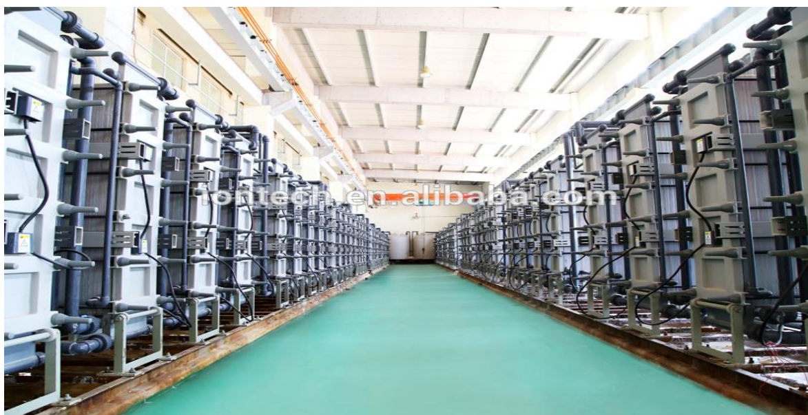
Εικόνα 10: Εγκαταστάσεις αφαλάτωσης με ηλεκτροδιάλυση στην Zhejiang της China [Πηγή: http://glossary.periodi.com ]
