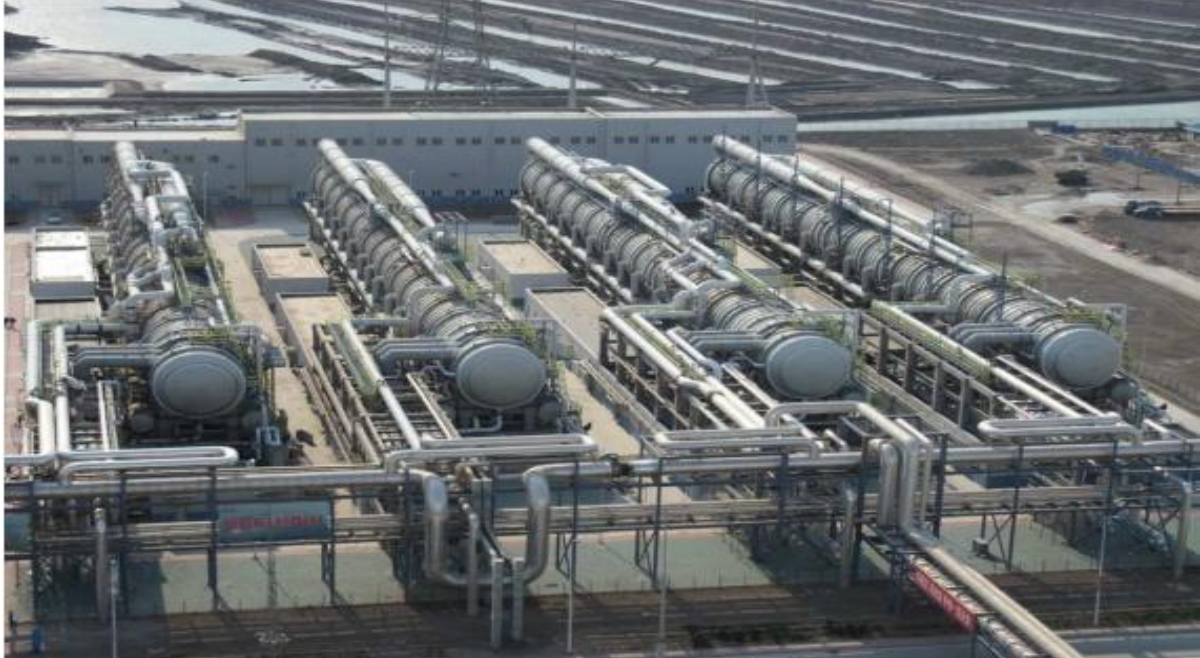
Εικόνα 6: Εγκατάσταση πολυβάθμιας εξάτμισης στην Κίνα. [Πηγή: Συσκάκη, 2013]
