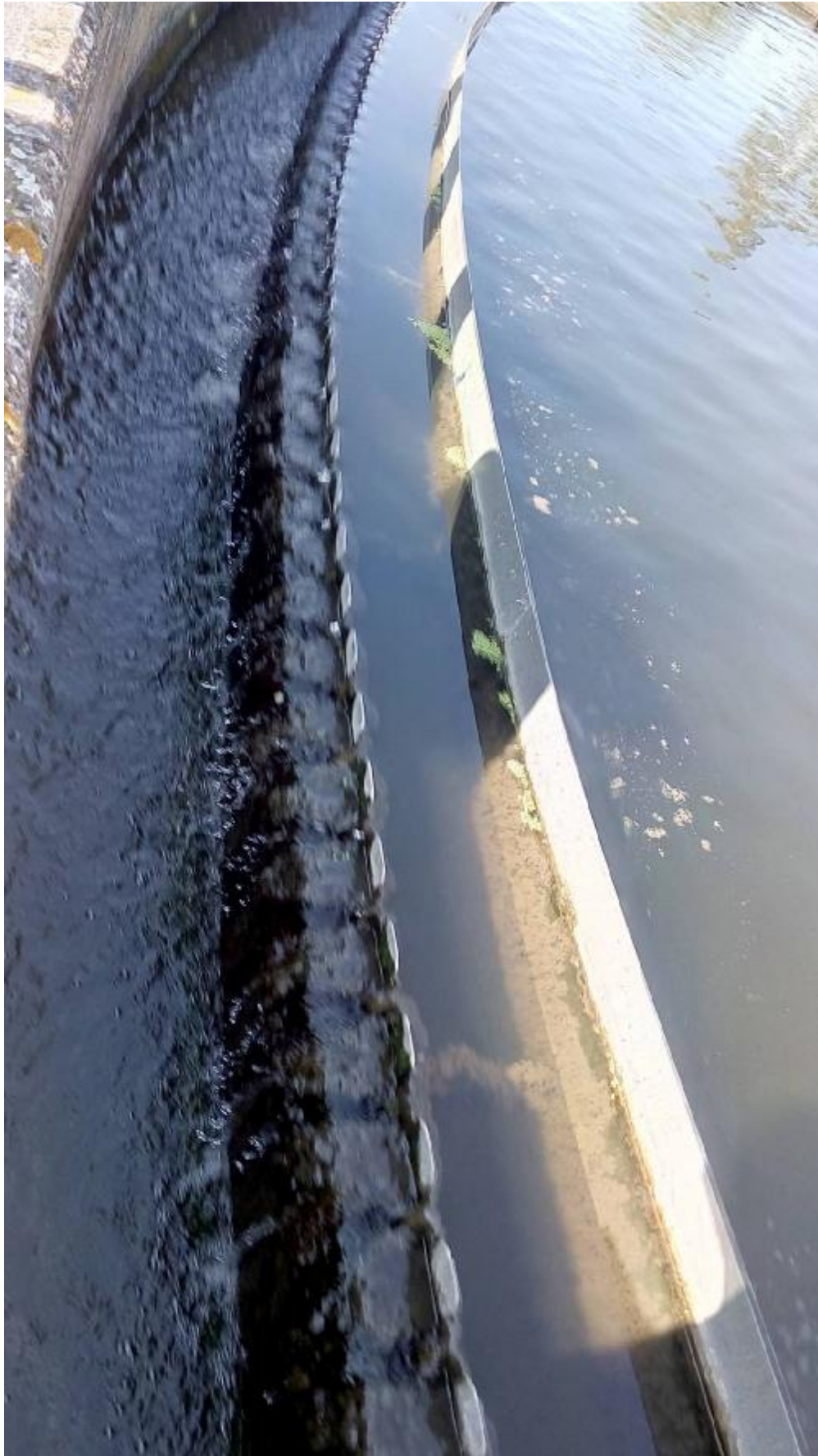
Εικόνα 26.Υπερχείλιση δεξαμενής καθίζησης.
