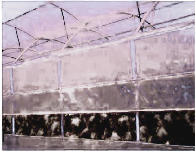
Εικόνα 2.3. Φυσικός εξαερισμός θερμοκηπίου
