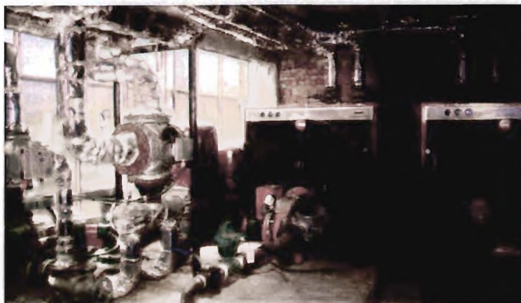
Εικόνα 5.4. Λεβητοστάσιο για κεντρικό σύστημα θέρμανσης με θερμό νερό
