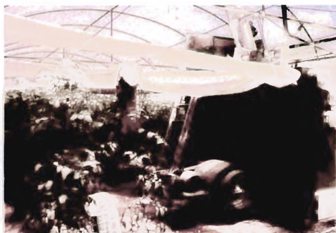
Εικόνα 5.6. Σωλήνες κατανομής ζεστού ατμού από το αερόθερμο
