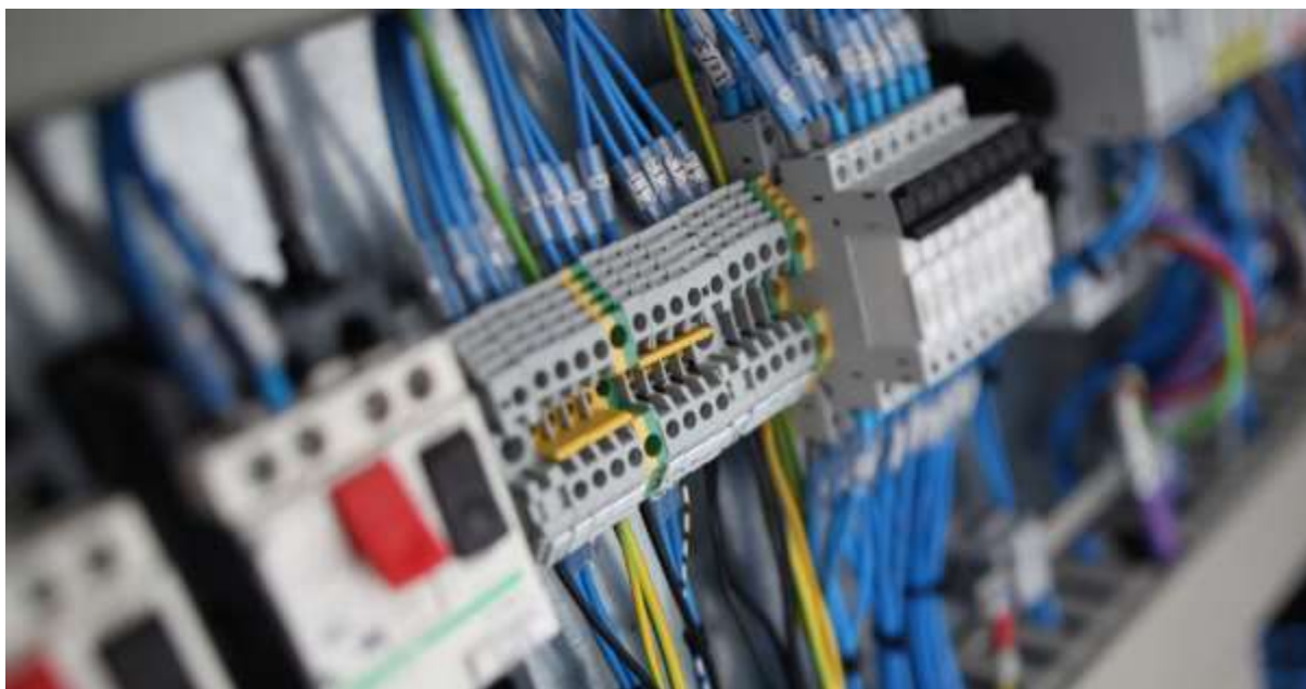
Εικόνα 34: Ηλεκτρολογικός πίνακας εγκαταστάσεων [156]
