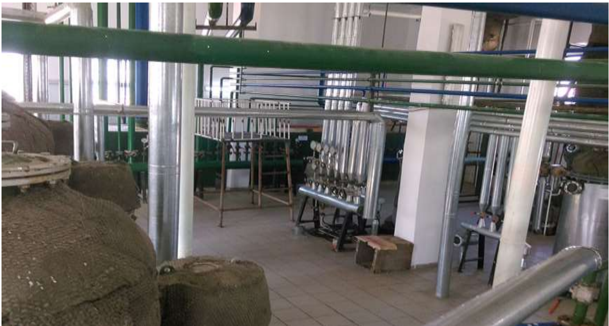
Εικόνα 11: Εγκατάσταση απόσταξης γλυκερίνης (σωληνώσεις) [70]
