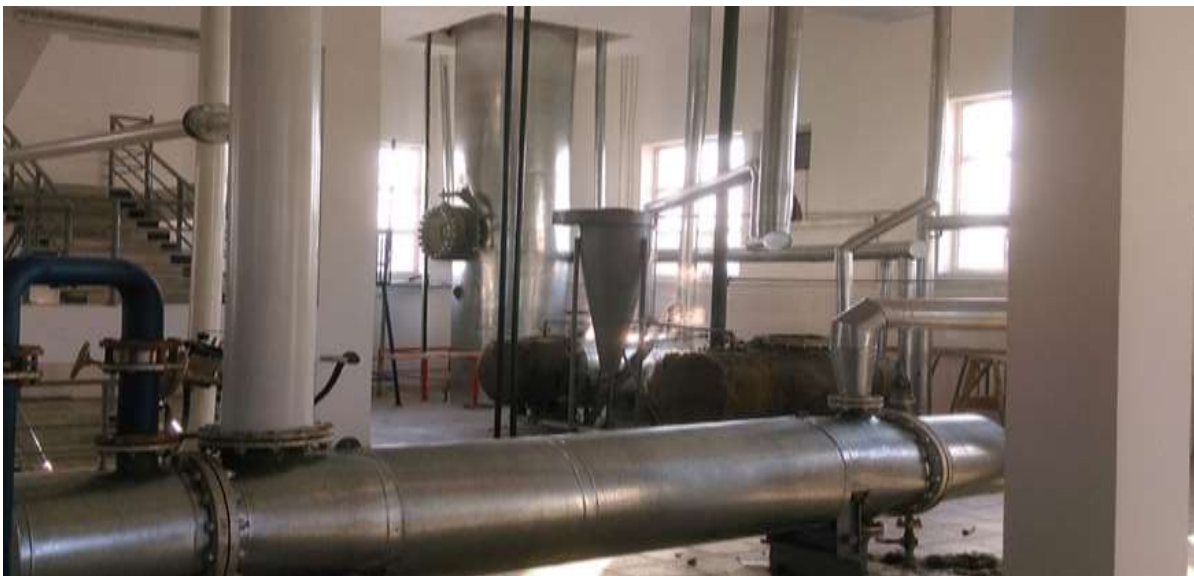
Εικόνα 7: Εγκατάσταση διάσπαση λίπους [71]
