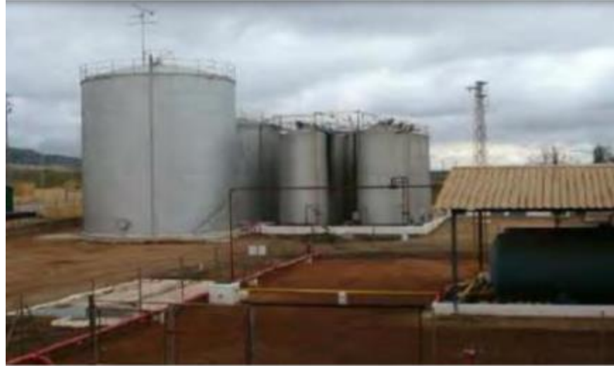
Εικόνα 12: Δεξαμενές αποθήκευσης πυρηνέλαιου (EUBIONET 2, 2007)
